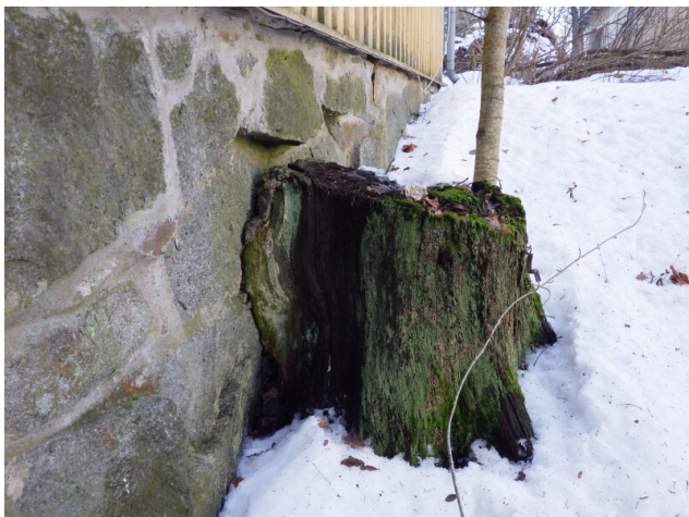
1. Rakennuksen päädyssä lahonnut puunkanto
