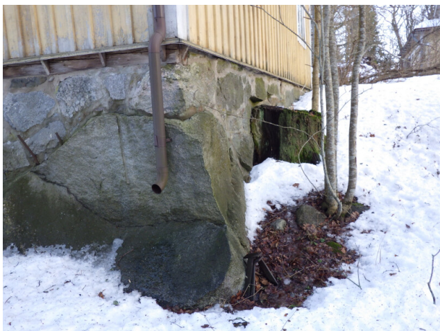
13. Syöksytorven vesiä ei ole ohjattu pois vierustalta
