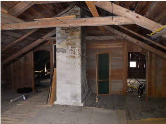
28. Yläpohjatilaa ja savupiippua. Kuvassa näkyy huonetilan seinää. Yläpohjarakenteiden päällä havaittiin kosteusjälkiä.
