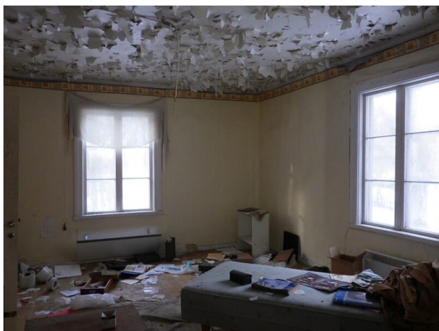
41. Sisätilojen pinnoilla havaittiin kosteusjälkiä, kosteuden tiivistymistä sekä kosteus- ja mikrobivaurioita.
