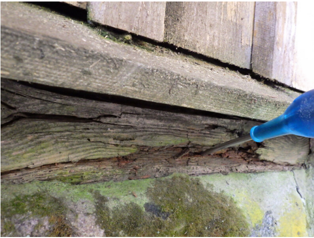
20. Ulkoseinän alaosassa lahovaurioita.
