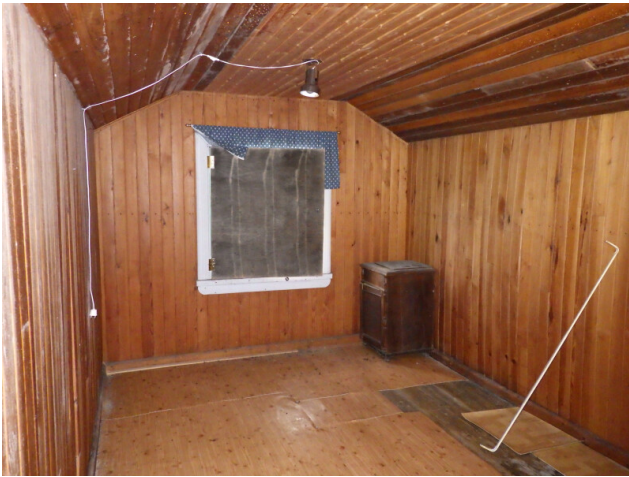
30. Huonetilaa jonka pinnoilla silmin havaittavaa mikrobikasvustoa ja kosteusjälkiä
