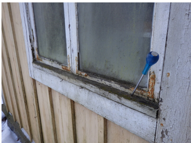
21. Ikkunan ulkopuitteessa, karmissa ja pielilautoissa lahoa
