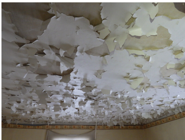
42. Katon maalipinta irronnut
