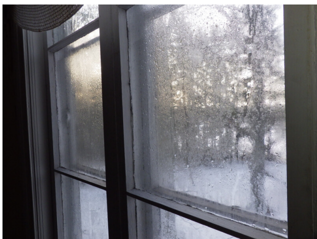
43. Ikkunalasin sisäpintaan tiivistynyttä kosteutta
