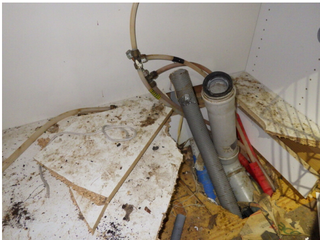
50. Vesijohtoja ja viemäriputkia keittiön allaskaapista
