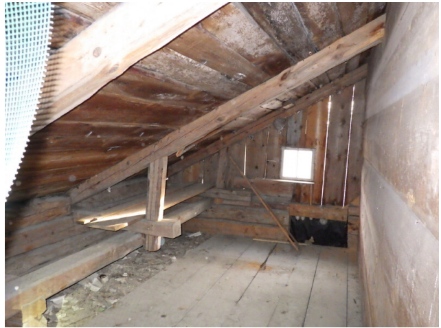
31. Yläpohjarakenteiden päällä havaittiin kosteusjälkiä
