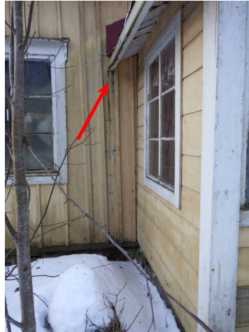
19. Verannan rännivedet valuneet ulkoseinälle (ks. nuoli). Ulkoverhouksessa ja ulkoseinän alaosassa lahovaurioita (ks. seuraava kuva).
