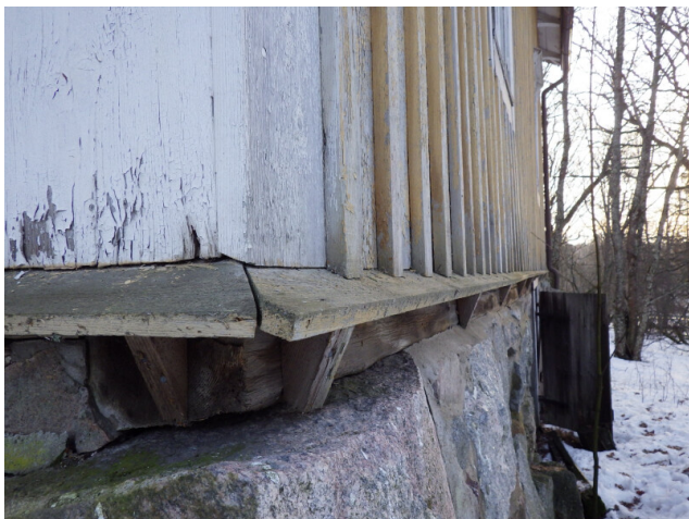
16. Julkisivun/ulkoseinän alaosa. Hirressä lahoamista.
