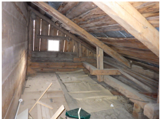
33. Yläpohjarakenteiden päällä havaittiin kosteusjälkiä
