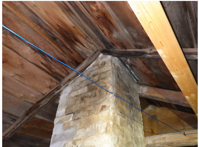
29. Savupiipun yläosassa vuotojälkiä
