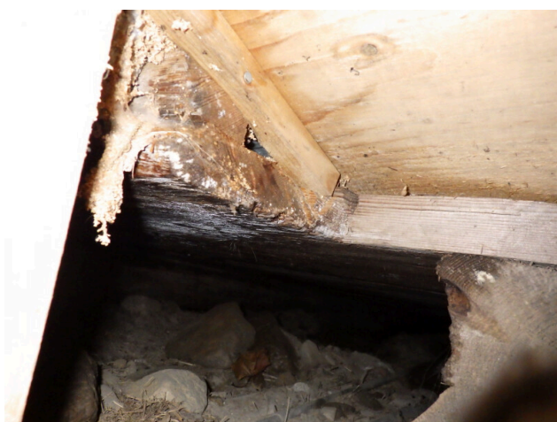
12. Ryömintätilaa tuuletusaukon kohdalta kuvattuna. Alapohjarakenteissa silmin havaittavia kosteus- ja mikrobivaurioita sekä lahovaurioita.
