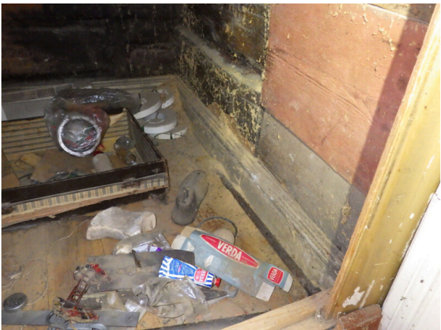
63. Portaikon alustilassa "sahanpurua" mikä viittaa tuholaishyönteisten aiheuttamaksi
