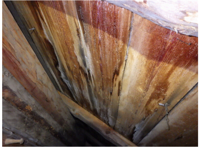
45. Aluslaudoituksessa silmin havaittavaa kosteutta ja "kuuraa"
