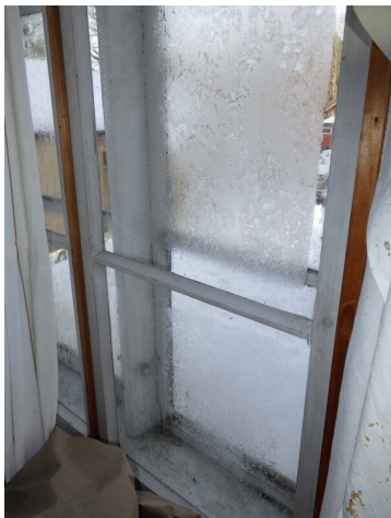
76. Alakerran ikkunan sisäpinnoille tiivistynyt kosteutta
