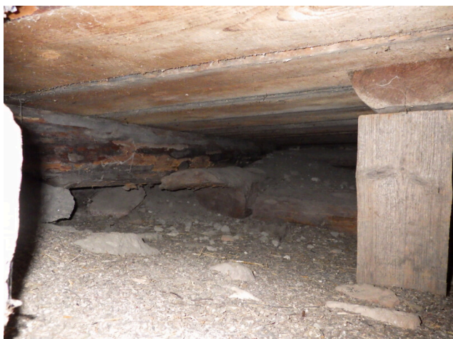
9. Ryömintätilaa tuuletusaukon kohdalta kuvattuna. Maapohja kiinni osin alapohjarakenteissa ja alapohjarakenteissa silmin havaittavaa mikrobikasvustoa.
