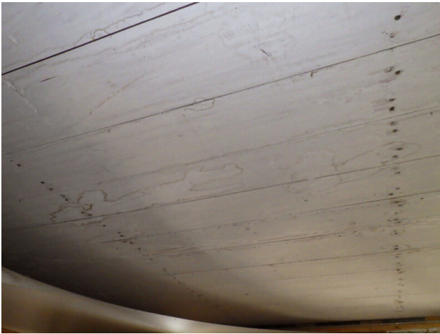
82. Lähikuvaa olohuoneen kosteusjäljistä
