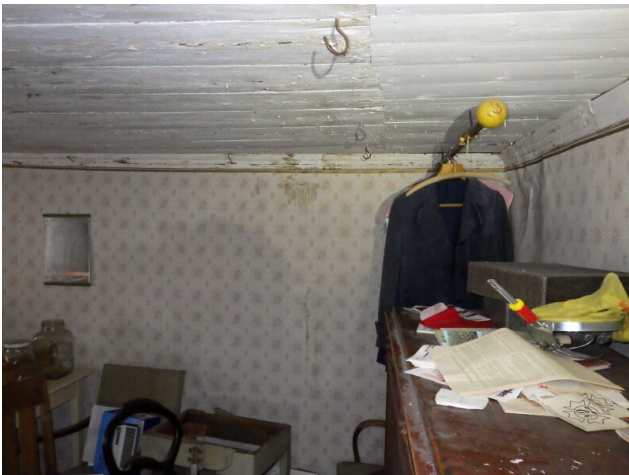
84. Katon pinnoite irronnut kosteuden takia ja seinän pinnalla kosteusjälkiä
