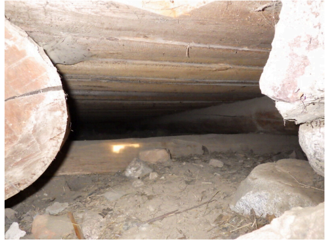
14. Ryömintätilaa tuuletusaukon kohdalta kuvattuna. Maapohja kiinni osin alapohjarakenteissa ja alapohjarakenteissa silmin havaittavaa mikrobikasvustoa.
