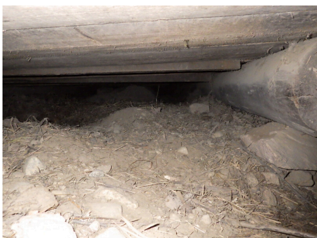
11. Ryömintätilaa tuuletusaukon kohdalta kuvattuna. Maapohja kiinni osin alapohjarakenteissa ja alapohjarakenteissa silmin havaittavaa mikrobikasvustoa.
