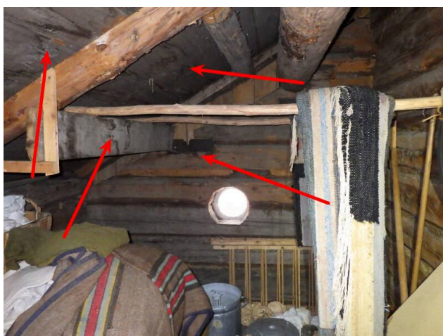
41. Ulkoseiniä sivu-ullakolta kuvattuna. Ulkoseinän pinnoilla ja vesikaton aluslaudoituksessa kosteus-/valumajälkiä.
