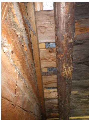
39. Peltikatteen alapuolella ei havaittu aluskatetta sivu-ullakoiden kohdalla
