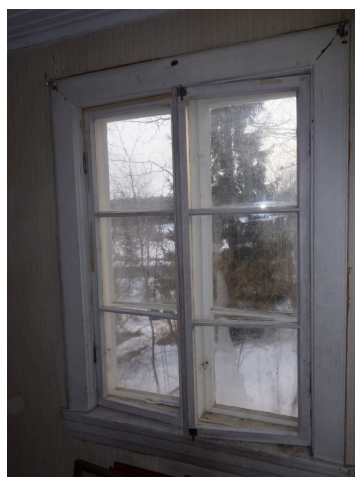
75. Alakerran ikkunan sisäpinnoille tiivistynyt kosteutta
