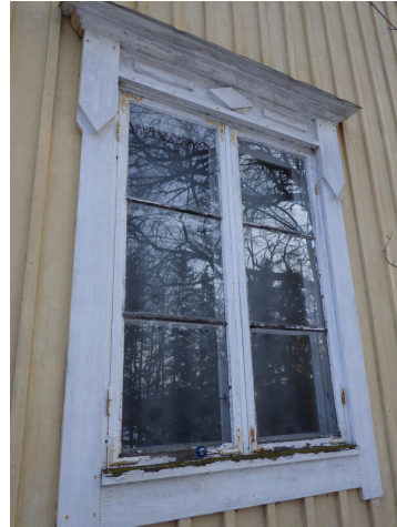
30. Ikkunan karmeissa ja ulkopuitteissa havaittiin lahoamisen aiheuttamaa pehmenemistä pistopiikillä
