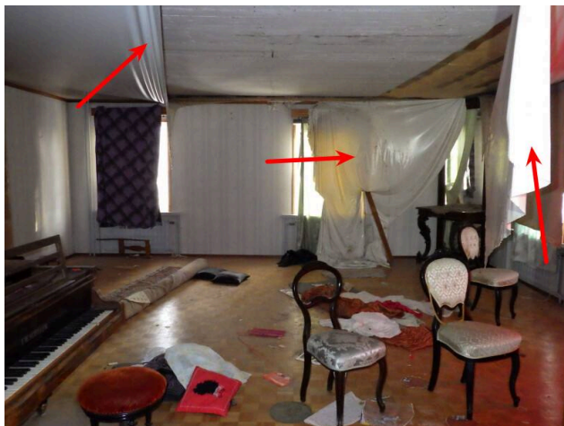
81. Alakerran "olohuoneen" katossa yleisesti kosteusjälkiä vaurioituneen/roikkuvan kattopinnoitteen taustalla (nuolet), ks. seuraava kuva
