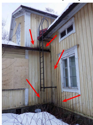
26. Rännivedet valuvat ulkoseinille (ks. nuolet). Ulkoverhouksessa lahovaurioita ja silmin havaittavaa kosteutta ko. alueella.
