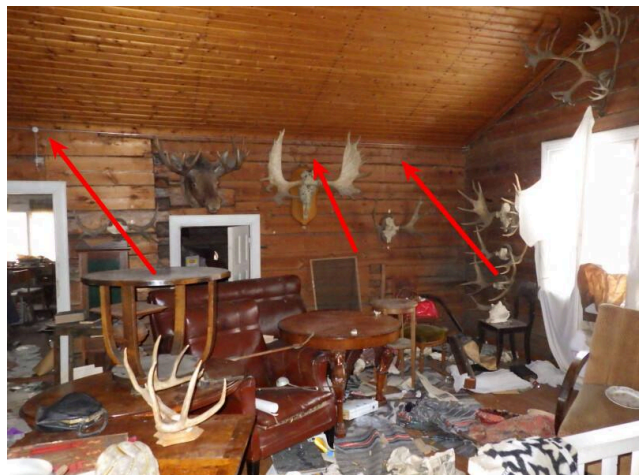
87. Laajennusosan seinäpinnoilla valumajälkiä, ks. myös seuraavat kuvat
