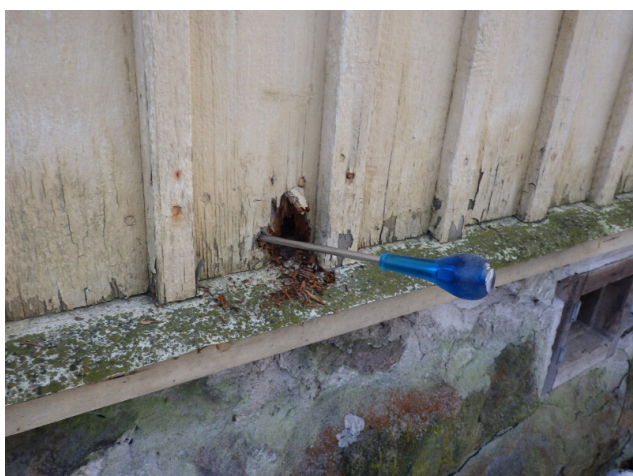
25. Verhouksen alaosassa ja sen taustalla olevassa hirressä lahovaurioita (kuva päädyistä)
