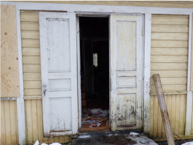
33. Ulko-ovet ovat lahovaurioituneet
