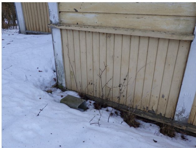
18. Kuistin alaosassa lahovaurioita ja maanpinta lähellä puurakenteita (ns. matala sokkelikorkeus)
