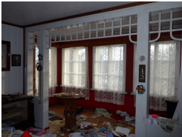
77. Erkkerin ulkoseinän yläosassa ja katossa vesikaton vuotoon viittaavia jälkiä, ks. seuraava kuva
