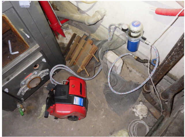
69. Lämmityskattilan öljypoltin lattialla irrallisena
