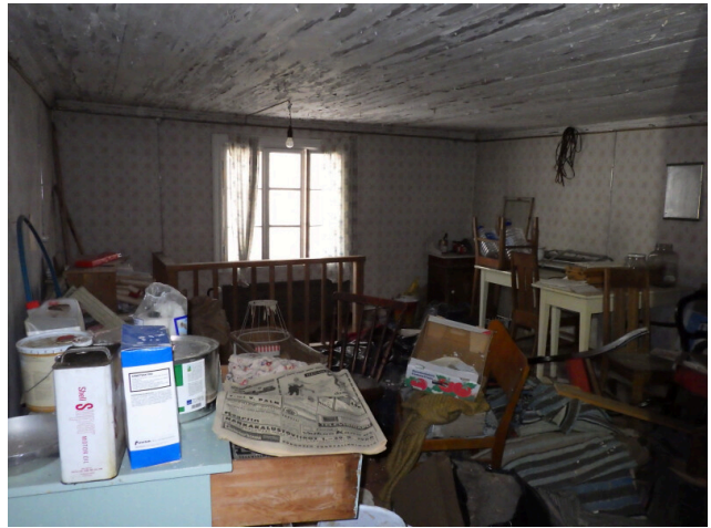
83. Yläkerran huonetilan katon pinnoite irronnut kosteuden takia. Seinä pinnoilla kosteusjälkiä, ks. seuraava kuva.
