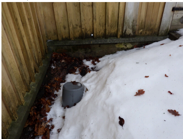
20. Verhouksen alaosassa lahovaurioita
