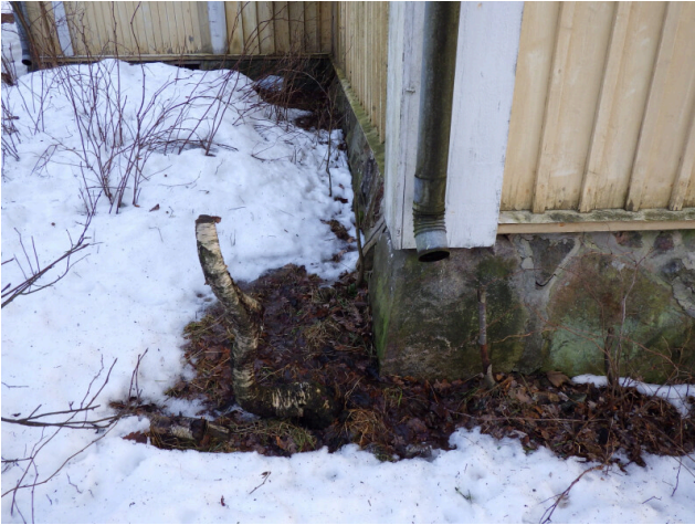
15. Rännivesiä ei ole ohjattu pois vierustalta
