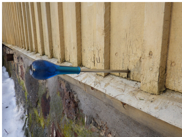
22. Verhouksen alaosassa lahovaurioita
