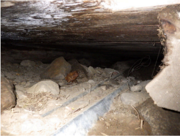
13. Ryömintätilaa tuuletusaukon kohdalta kuvattuna. Alapohjarakenteissa silmin havaittavia kosteus- ja mikrobivaurioita sekä lahovaurioita.
