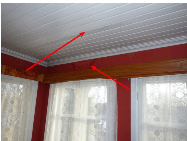
78. Erkkerin ulkoseinän yläosassa ja katossa vesikaton vuotoon viittaavia jälkiä
