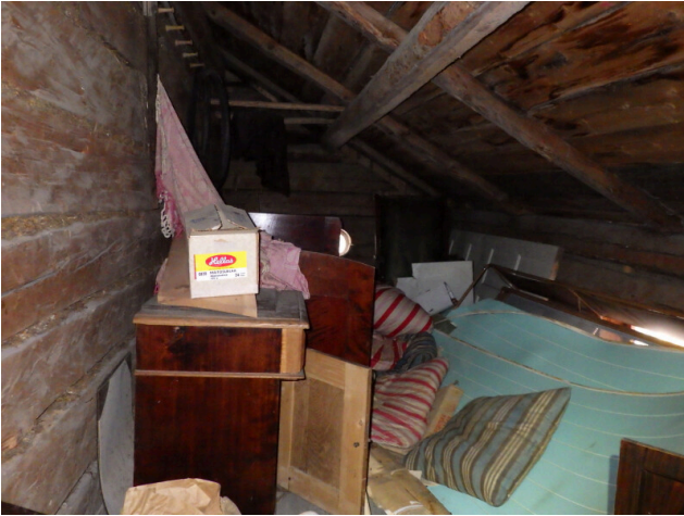
44. Ulkoseiniä sivu-ullakolta kuvattuna. Ulkoseinän ja yläpohjan pinnoilla sekä vesikaton aluslaudoituksessa kosteus-/valumajälkiä.
