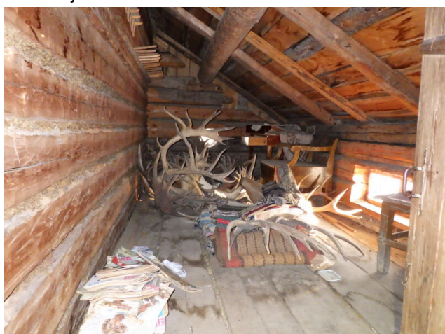
42. Ulkoseiniä sivu-ullakolta kuvattuna. Ulkoseinän ja yläpohjan pinnoilla sekä vesikaton aluslaudoituksessa kosteus-/valumajälkiä.
