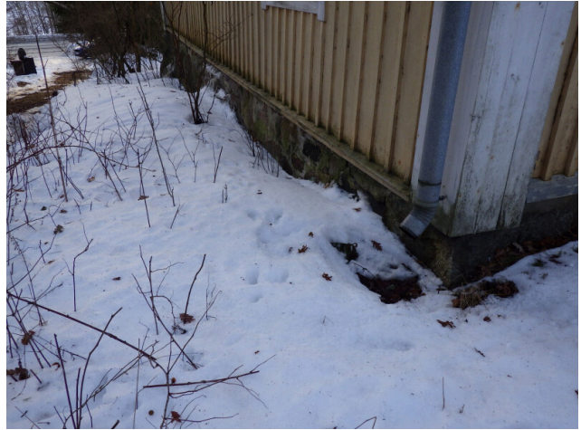
16. Rännivesiä ei ole ohjattu pois vierustalta
