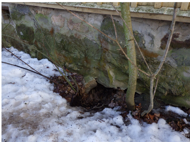
7. Rakennuksen päädyn perusmuurin ali oli kaivettu "onkalo"
