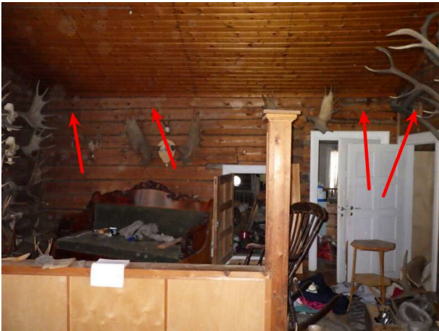
90. Laajennusosan seinäpinnoilla valumajälkiä, ks. myös seuraavat kuvat
