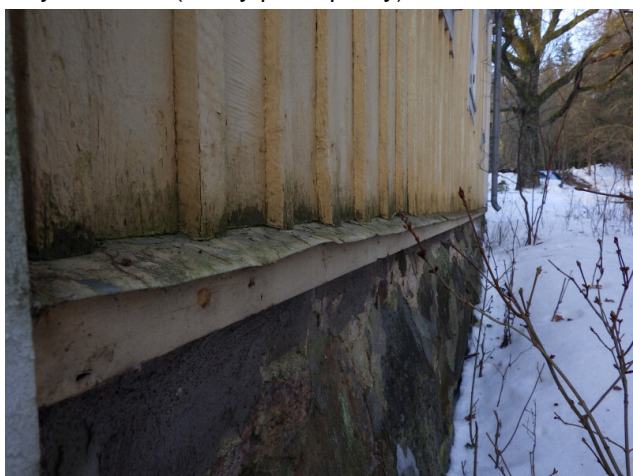
23. Verhouksen alaosassa lahovaurioita
