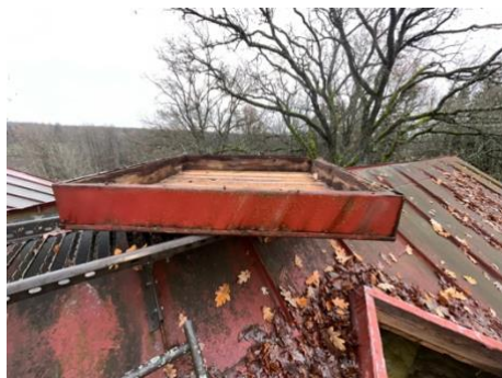
Luukussa ei ollut turvaketjua tms. Asennettava.
