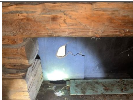
Ulkoverhouksen taustalla on tervapaperi. Paperissa havaittiin PAH-yhdisteiden hajua
