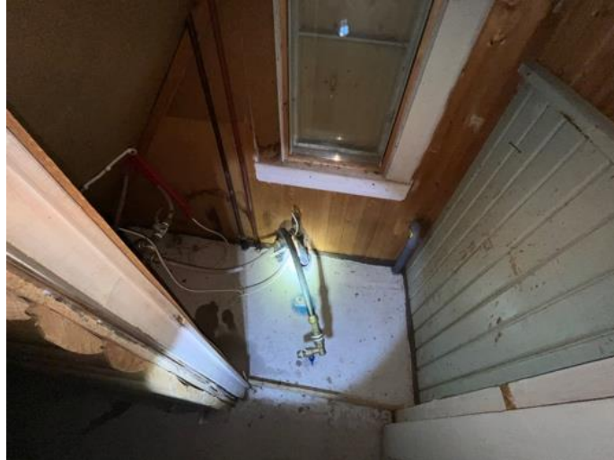
Pesuhuoneessa sijaitsevan tulovesijohdon päässä olevasta sulkuhanasta tuli paineella vettä tarkastuksen aikana
