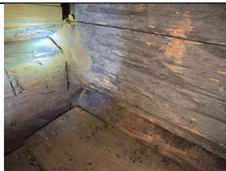
Sivu-ullakoilla hirsirungossa havaittiin laho- ja hyönteisvaurioita.
