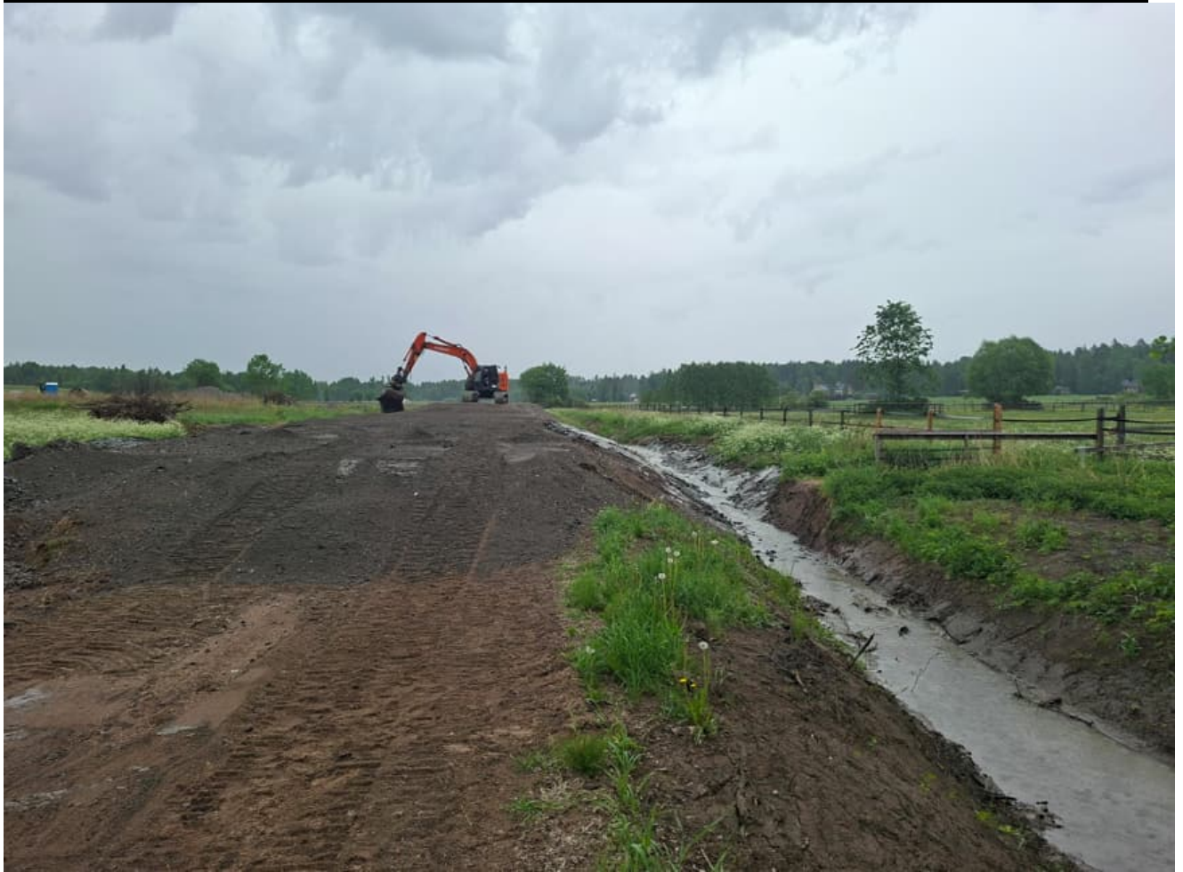
Kaivinkone on jo avannut umpeen menneen ojan sortuman jäljiltä. ymp.tark. 9.6.2026
