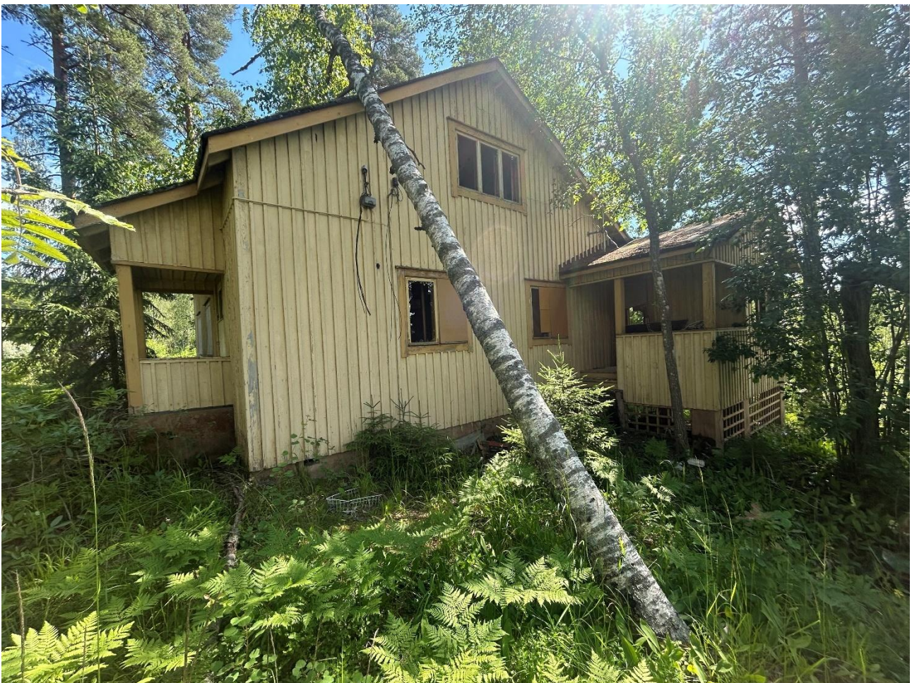
Bild 4. På lägenhet 2:207 inom planeringsområdet finns en bostadsbyggnad från 1950-talet som har utsatts för vandalism. Till gårdsområdet hör två byggnader och båda är i rivningskick.
