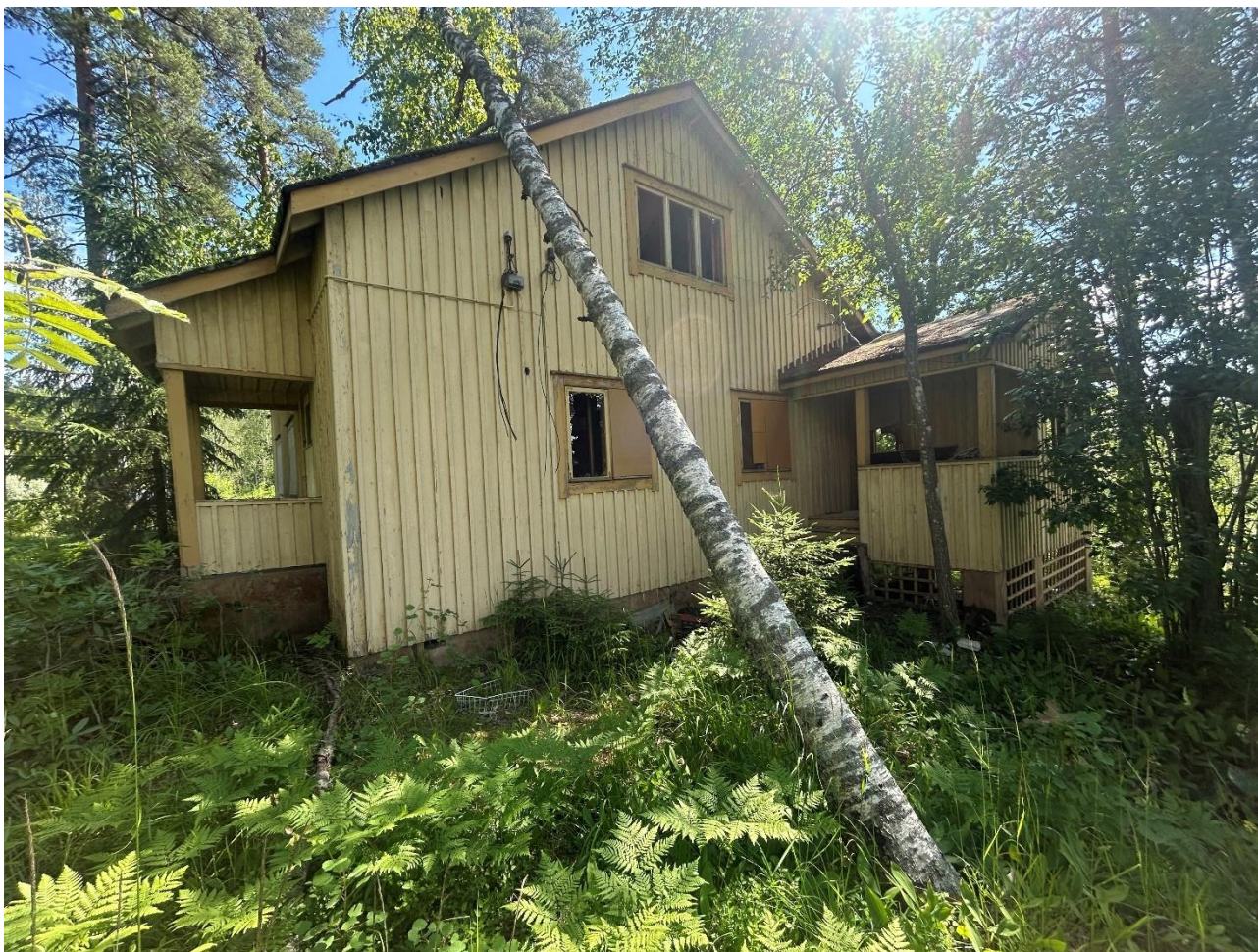
Kuva 4. Suunnittelualan tilalla 2:207 sijaitseva ilkeäkohteeksi joutunut asuinrakennus 1950-luvulta. Pihapiiriin kuuluu kaksi rakennusta ja ne molemmat ovat purkukuntoisia.
