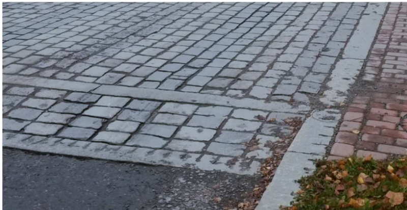
Kuva 11. Luonnonkivet erottavat luiskan muusta katualueesta (kuva: Milla Rusanen, Hervanta, Tampere).
