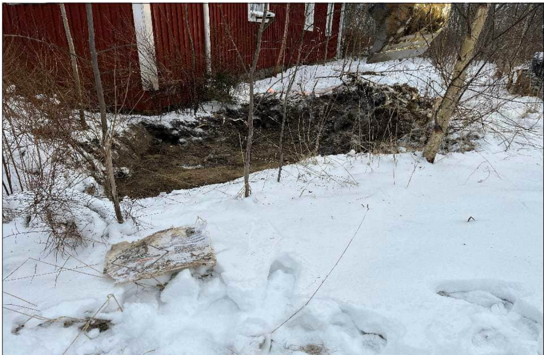
Kuva 12. Kaivualue punainen tupa rakennuksen pohjoispuolella 14.6.26. Kaivualueen seinämästä ja pohjalta otettiin jäännöspitoisuusnäyte N18.
