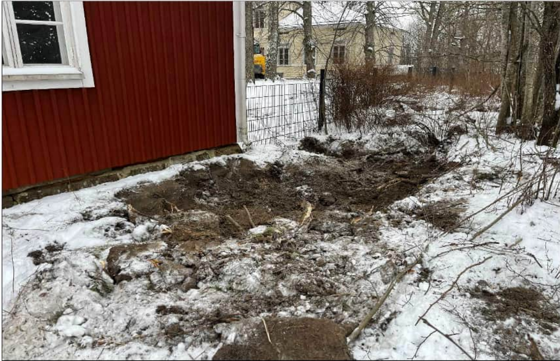
Kuva 11. Kaivualue punainen tupa rakennuksen länsipuolella 14.6.26. Kaivualueen seinämästä ja pohjalta otettiin jäännöspitoisuusnäyte N19.
