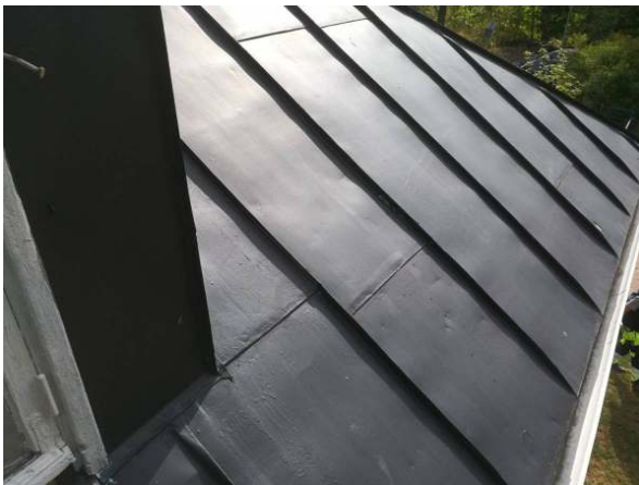
19. Vesikatolla ei ole järjestetty huoltoreittiä.
