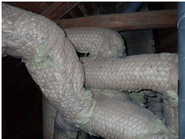
35. Kanavat on eristetty yläpohjatilassa.
