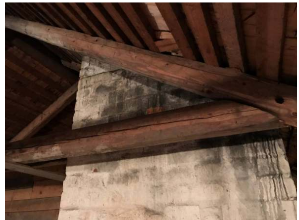
2. Savuhormissa on mikrobivaurio.
