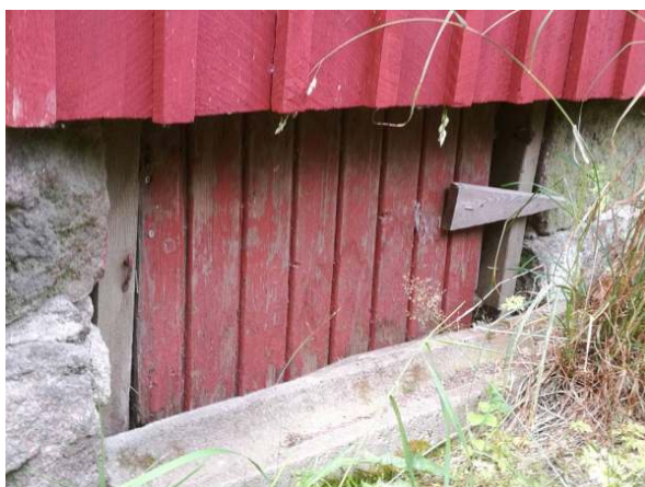
10. Alapohjan luukku oli ruuvattu kiinni.
