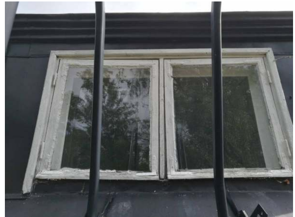
16. Yläpohjan ikkuna on kunnostuksen tarpeessa.
