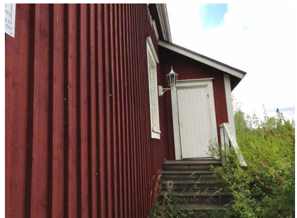
18. Ulko-ovet ovat pääosin tyydyttävässä kunnossa.
