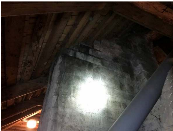
1. Savuhormissa on mikrobivaurio.
