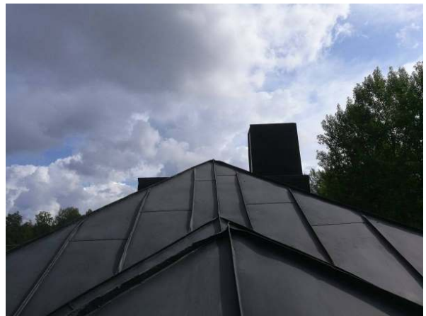
20. Vesikatolla ei ole järjestetty huoltoreittiä.
