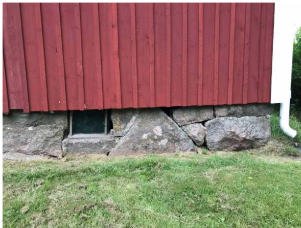
8. Sokkelit ovat painuneet ja ovat yleisesti heikossa kunnossa.
