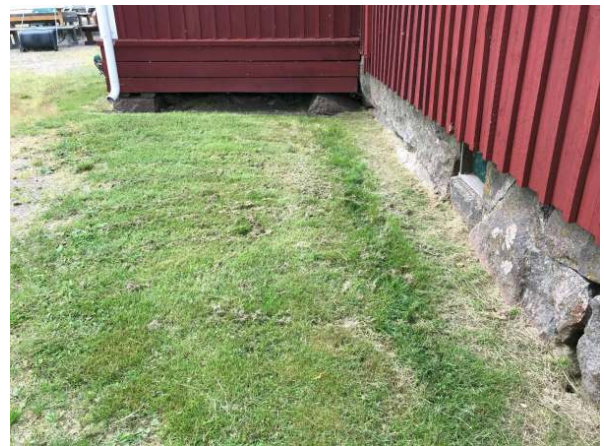
9. Sokkelit ovat painuneet ja ovat yleisesti heikossa kunnossa.
