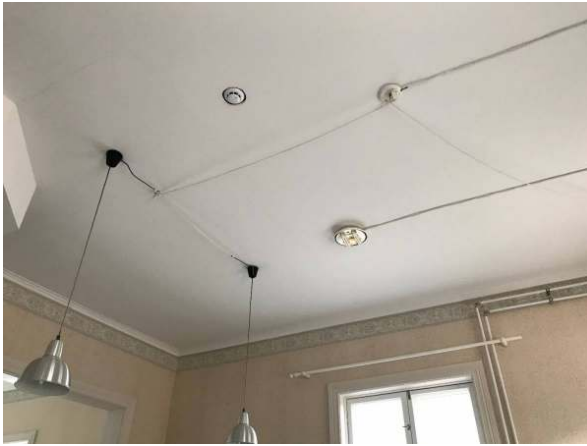
33. Välipohjan painumisen takia katto on levytetty uusiksi.
