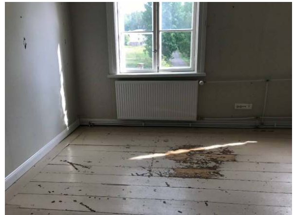
36. Lattiapinnat kaipaavat huoltomaalausta.
