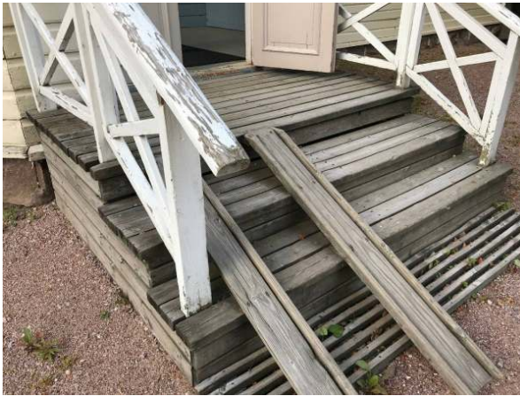
29. Pääoven portaat ovat kunnostuksen tarpeessa.
