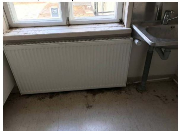
38. Keittiön lattia- ja seinärakenne on saatujen tietojen mukaan heikossa kunnossa.
