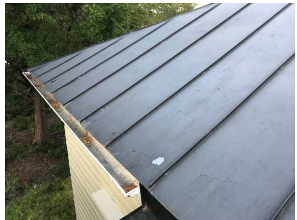
32. Peltikate on huoltomaalauksen tarpeessa.
