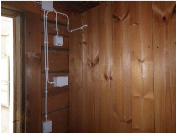
63. Sähkökalusteita yhteisissä tiloissa.
