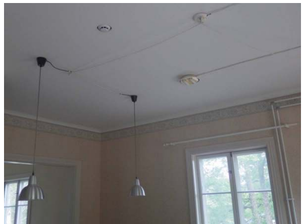
80. Paloilmaisin (ja korjattavia valaisinasennuksia).
