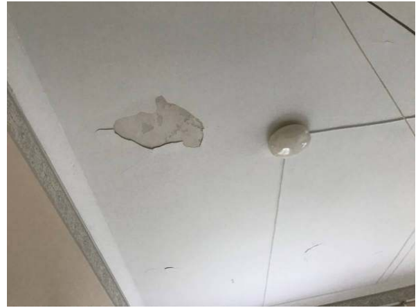
34. Sisäkattot kaipaavat huoltomaalausta.
