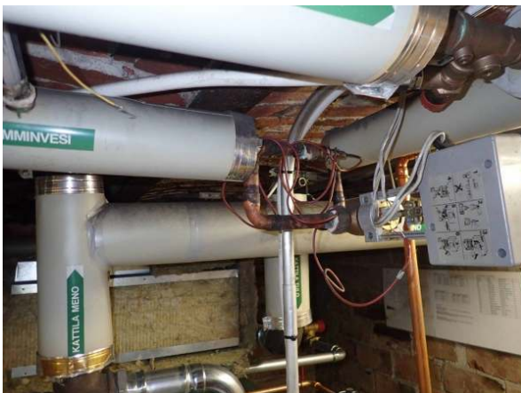
47. Vesijohdot ovat kuparia.
