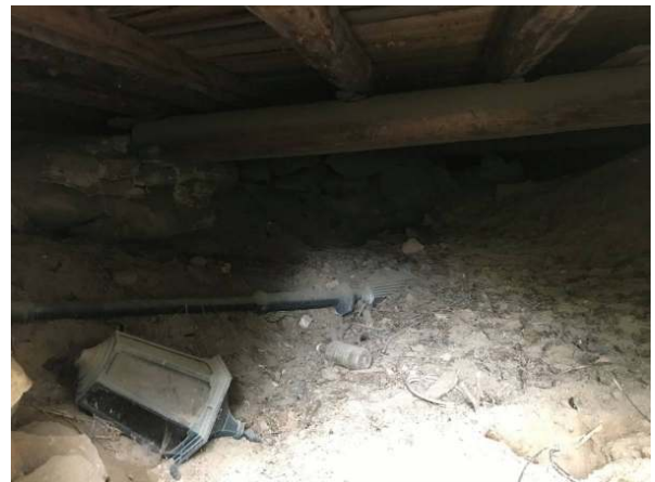
22. Alapohjatilassa on roskaa.
