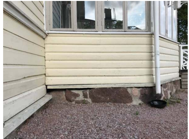
20. Kuistin sokkeli on painunut.
