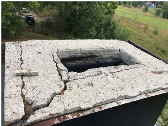
2. Savuhormin halkeamista sadevettä on päässyt seinä- ja yläpohjarakenteisiin.
