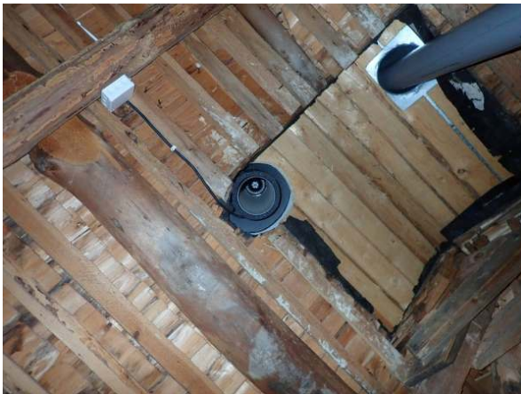
53. Huippumuri oli turhaan käynnissä ullakolla.
