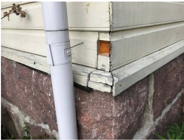
25. Paikallinen vaurio ulkoverhouksessa.
