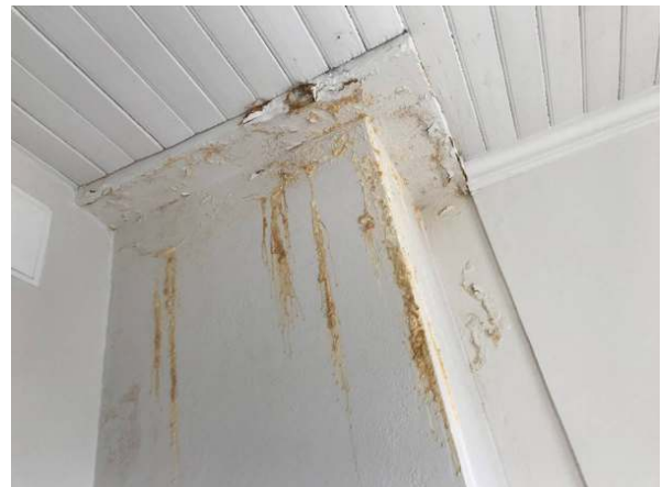
3. Savuhormin halkeamista sadevettä on päässyt seinä- ja yläpohjarakenteisiin.
