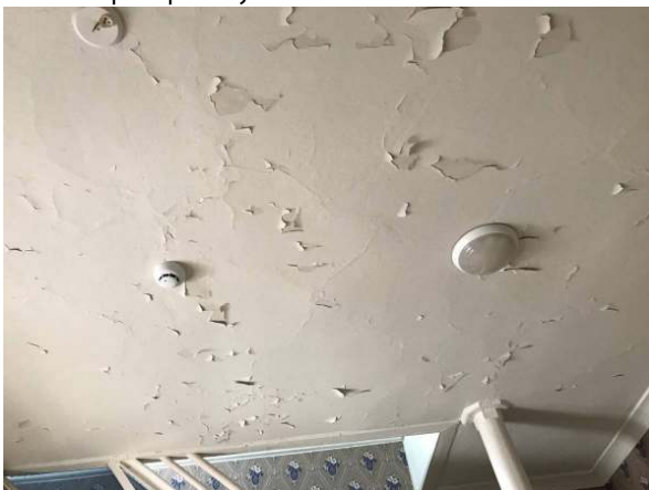
37. Sisäkattot kaipaavat huoltomaalausta.
