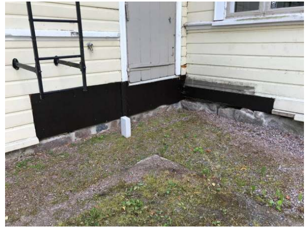
30. Ulko-ovet portaat on uusittava julkisivuverhouksen uusimisen yhteydessä.
