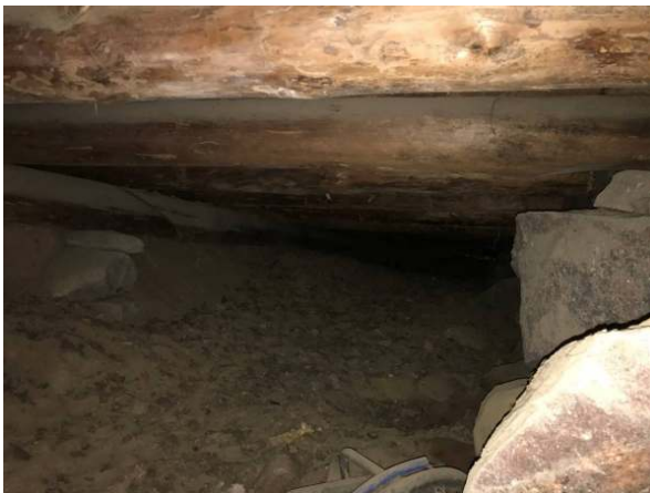
21. Alapohjatilassa on roskaa. Maa-aines on pääosin hienoa hiekkaa.
