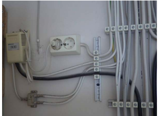
64. Sähkökalusteita teknisessä tilassa.
