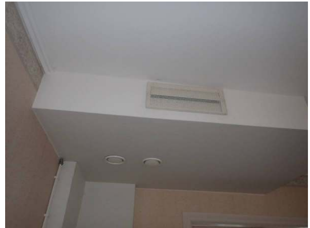
56. Tulo- ja poistoilmaventtiilejä.
