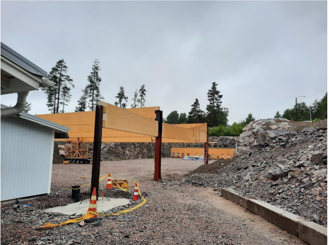
Kuva 1. Rata-alue, tausta- ja sivuvallit sekä kulissit
