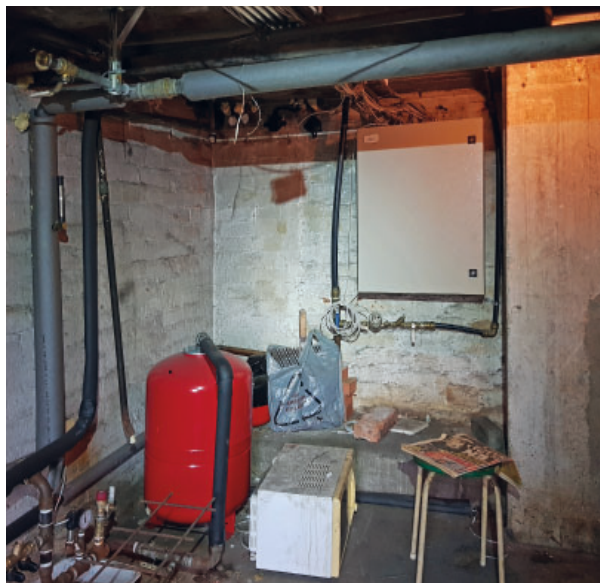
Kuva 38. Lämmönjakohuoneen yhteydessä oleva varastotila
