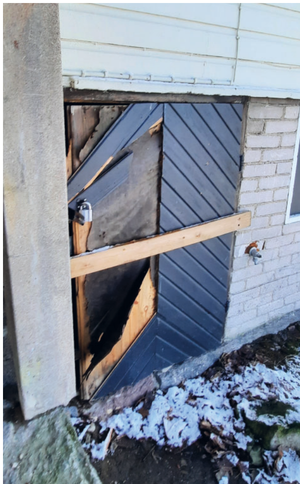
Kuva 55. Lämmönjakohuoneen murrettu ovi Pahoin vaurioitunut ovi murtojälkineen helmikuussa 2023. Kuva: Tuomo Könönen
