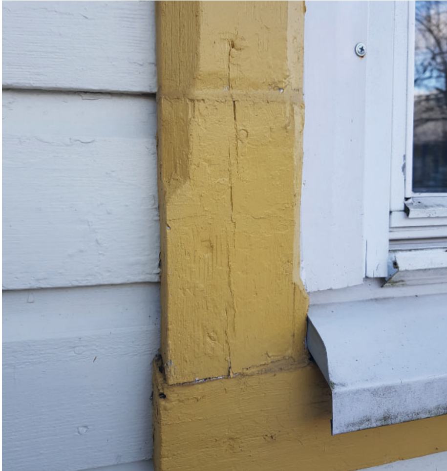
Kuva 53. Ikkunan jatkettu vuorilauta 1
