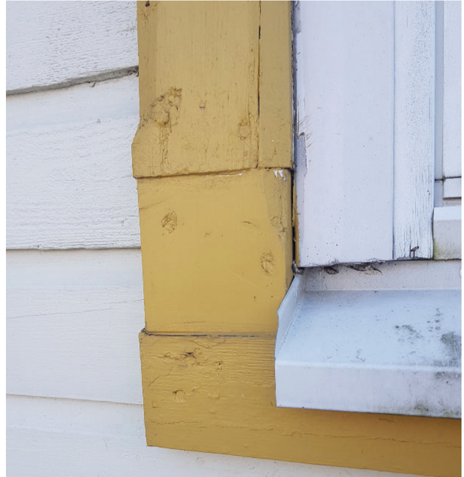
Kuva 54. Ikkunan jatkettu vuorilauta 2
