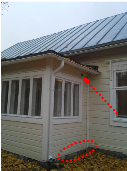
Kuva 22. Pääsisäänkäynnin erkkerin koillispuolen alimman julkisivulaudan alareunassa on lahovaurio, joka on ylimaalattu. Erkkerin ylänurkassa on tuuletussäleikkö.
