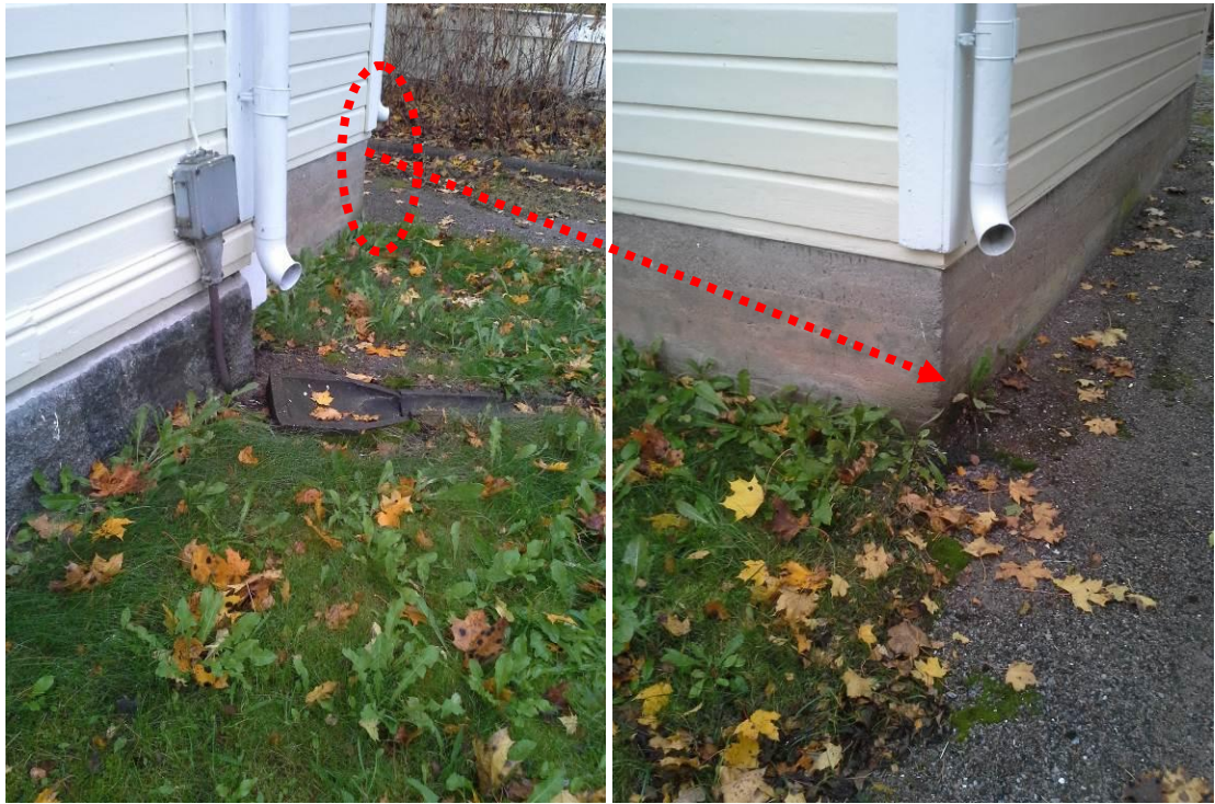
Kuvat 17 ja 18. Rakennuksen luoteisreunalla syöksytorvelta maahan tippuvat roiskevedet kastelevat perustusrakenteita. Kyseisillä kohdilla piha-alueella on vain loiva kaato rakennuksesta pois päin ja nurmialueen puolella syöksytorven alle on asennettu betoninen loiskekuppi, jonka kautta suurin osa vesistä valuu pois rakennuksen reunalta.
