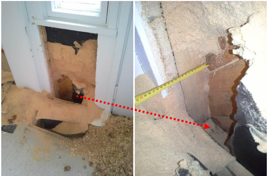
Kuvat 32 ja 33. Rakennuksen lounaispuolen erkkerirakenteen rakenneavaus RAK 1. Avauksesta havaittiin, että purueristetyssä seinässä on runsaasti PAH-yhdisteitä sisältävää voimakkaasti haisevaa tervapaperia. Purun alaosaa lattiapinnan tason alapuolella oli kosteaa ja seinän alajuoksupuuhun oli lahovaurioitunut. Puukko upposi kosteusvaurioituneeseen alajuoksupuuhun. Seinän alaosaan havaittiin mikrobiperaistä hajua.
