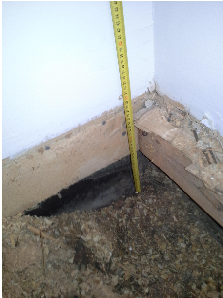
Kuva 56. Rakenneavaus RAK12 alapohjan ja väliseinän liittymään. Alapohjan eristeen alaosaan oli purun lisäksi turvetta ja hieman olkea. Muuten rakenne oli vastaava kuin muilla purueristetyillä osilla. Rakenteessa on väliseinän reunassa todennäköisesti asbestia ja PAH-yhdisteitä sisältävä kermieristys.
