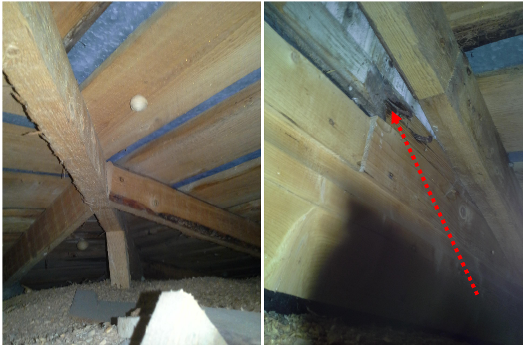
Kuvat 78 ja 79. Rakenneavaus RAK 9 (1. kerros). Erkkerin ullakkotila on matalampi kuin muilla osin. Tila oli pääsääntöisesti siisti. Vuotojäljeltä muistuttava värjäytymä nähtiin ulkoseinän ja lappeen liittymän kohdalla (oikea kuva).
