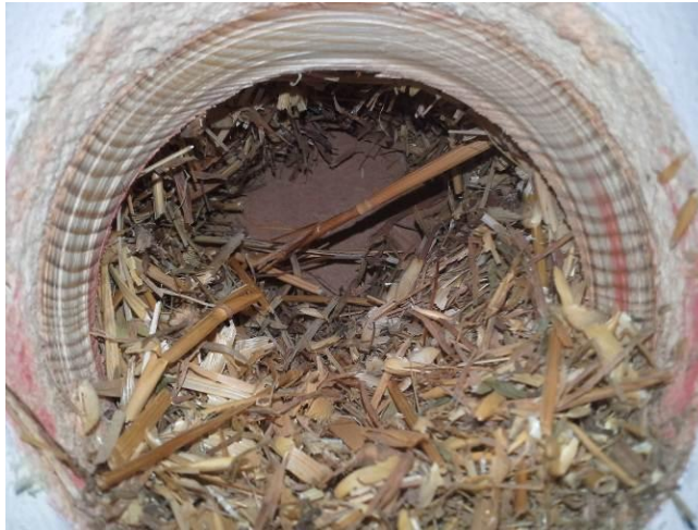
Kuva 37. Rakennuksen 2. kerrokseen tehty rakenneavaus (RAK 11). Rakenneavauksesta havaittiin, että hirren sisäpinnassa on käytetty olkea lisälämmöneristeenä. Rakenne oli kuiva eikä aistinvaraisesti havaittu poikkeamaa. Oljen materiaalinäytteen perusteella havaittiin lievä viite mikrobikasvusta materiaalissa.
