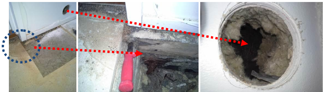
Kuvat 34-36. Pääsisäänkäynnin erkkerin rakenneavaus RAK 4. Ulkoseinän alaosa lattiapinnan tason alapuolella on lahovaurioitunut. Lämmöneristeenä ko. erkkerin seinässä on mineraalivilla. Todennäköisesti kyseinen rakenne on korjattu jossain vaiheessa. Seinän alaosan eristeestä lattiapinnan yläpuolel (oikean puoleinen kuva) eristeen materiaalinäytteessä todettiin viitteitä mikrobikasvusta materiaalista . Näytteessä todetut mikrobit voivat olla myös kulkeutunutta aivan seinän alaosaan pahemmin vaurioituneelta alueelta, josta todettiin ilmayhteys ko. rakenneosaan.
