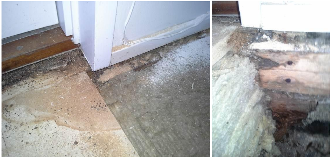
Kuvat 50 ja 51. Rakenneavaus RAK 4. Pääsisäänkäynnin oven nurkassa ja kynnyksessä on selkeät vesivuotojäljet. Oviaukon kohdalta on päässyt vuotovesiä lattiapinnalle, jotka ovat kastelleet rakenteen. Rakenneavauksesta todettiin ulkoseinän lahovaurioiden lisäksi, että alapohjan mineraalivillaeristeen alapinta oli kostunut (suhteellinen kosteus 96,1 % ja lämpötila 10,9 °C). Mineraalivillaeristeen alapinnassa todettiin materiaalinäytteessä mikrobikasvua materiaalissa . Betonipinnassa oleva bitumisively haisi voimakkaasti PAH-yhdisteille, kun pintaa rikkoi. Rakenteessa on ulkoseinän reunassa asbestia ja PAH-yhdisteitä sisältävä kermieristys.
