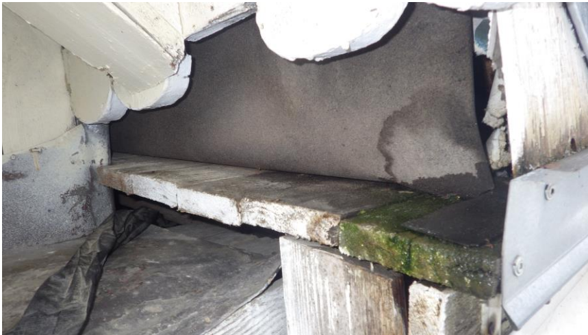
Kuva 3. Lähikuva rakenneavauksen 1 läheisyydestä julkisivun puolelta. Viistosade rasittaa rakennetta.
