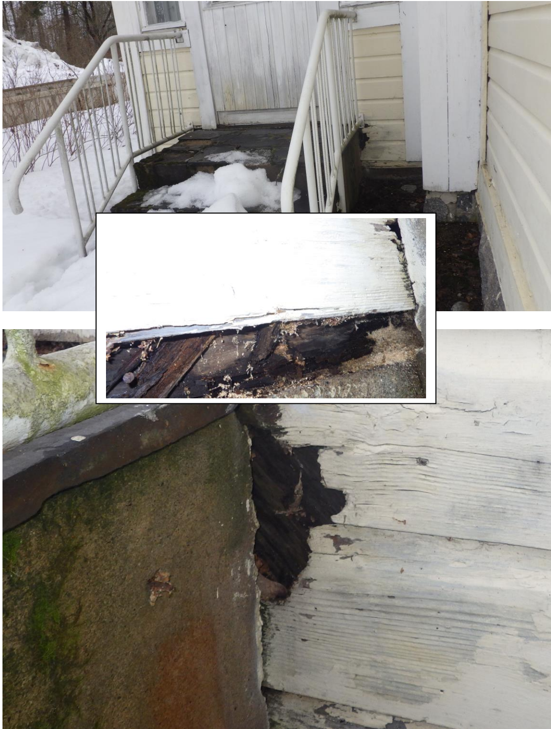
Kuva 9 a-b. Salin 1 erkkeriin johtavan portaikon ympärillä havaittiin merkittäviä lahovaurioita portaikon ja ulkoseinän liitoksissa.
