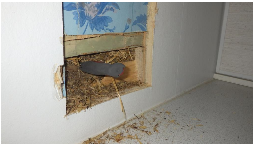
Kuvat 8 a-b. Rakenneavaus 4 toisen kerroksen makuuhuoneessa 2.
