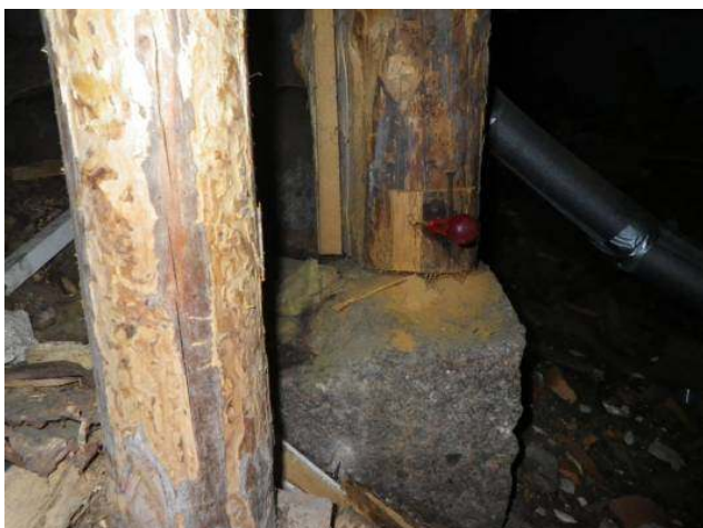
5. Alapohjaa tukevan pilarin alaosassa on laho/hyönteisvaurioitumista
