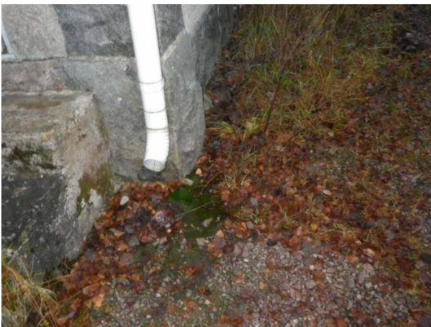
8. Katon sadevesien ohjausta
