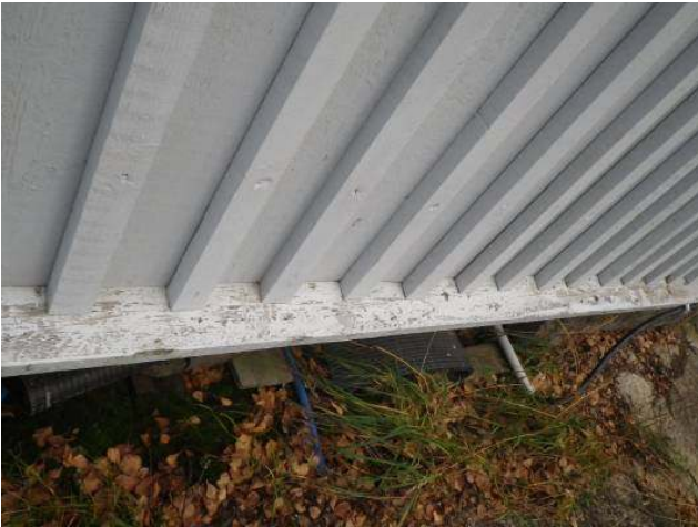
12. Tippalaudan maalipinnassa havaittiin hilseilyä
