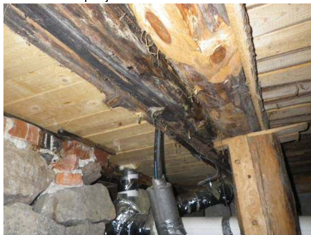
4. Keittiön alapuolella on alapohjan puurakenteissa kosteuden aiheuttamaa tummentumaa
