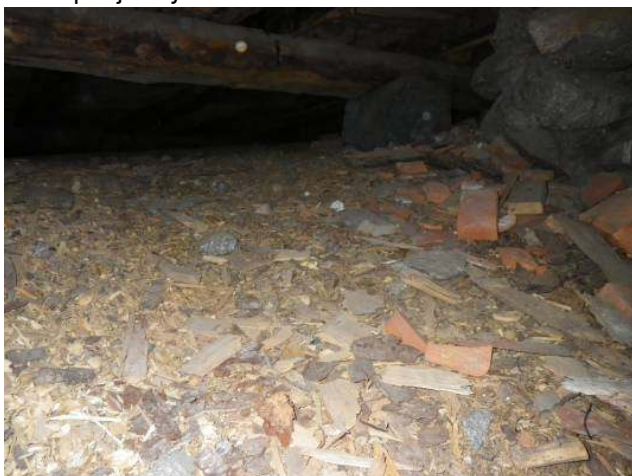
3. Ryömintätilan pohjalla on mm. puulastuja
