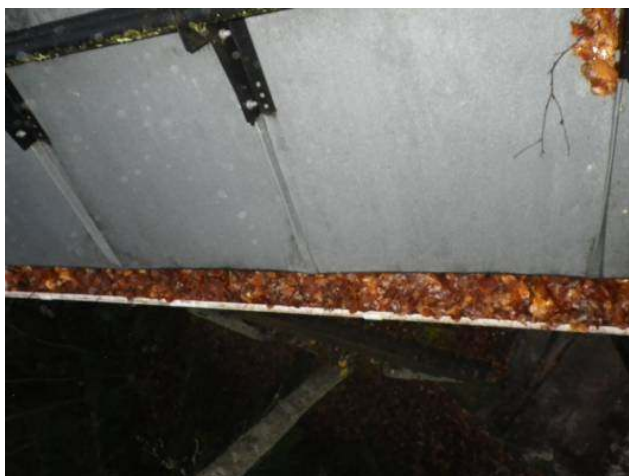
18. Sadevesikourussa on lehtiä
