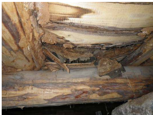
6. Salin alapuolella on alapohjarakenteissa kosteuden aiheuttamaa vaurioitumista
