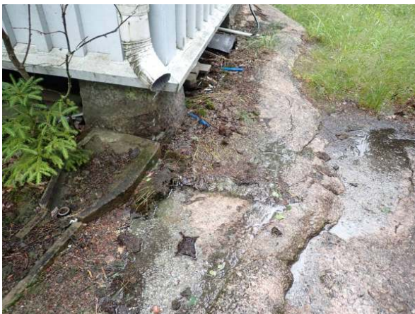
3. Sadevesiä ohjautuu vierustalle etupihan puolella.
