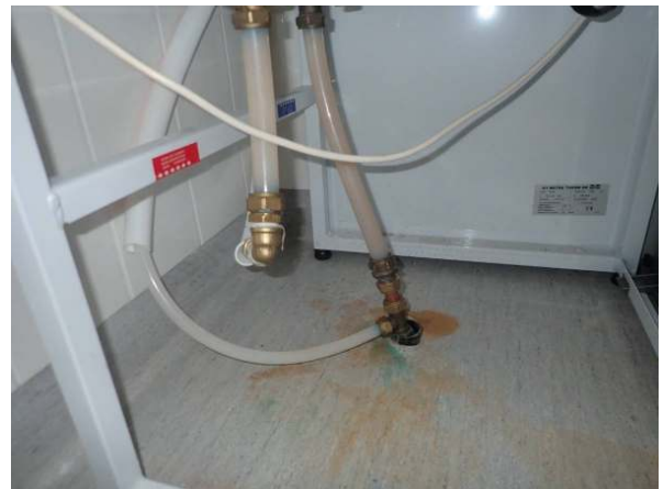
61. Lämminvesivaraaja on mallia Metro.
