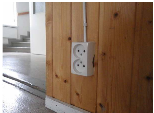
82. Rikkoutuneet sähkökalusteet tulee uusia välittömästi.
