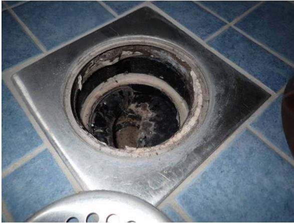
58. Lattiakaivossa on säädettävä kiristysrenkas, joka ei kuulu lattiakaivo malliin joten sen tiiveys tulisi varmistaa ennen tilan käyttöönottoa.
