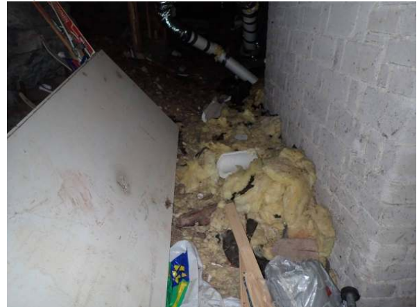
27. Alapohjatilassa on ylimääräistä rakennusjätettä.
