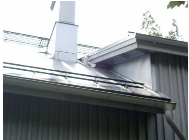
45. Katteen reunassa on vaurio pellityksessä.
