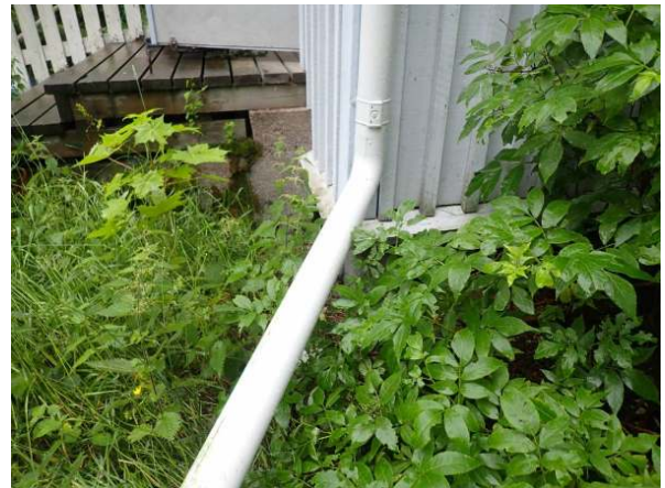
2. Sadevesiä on johdettu jatkoputkilla syöksytorvista kauemmaksi.
