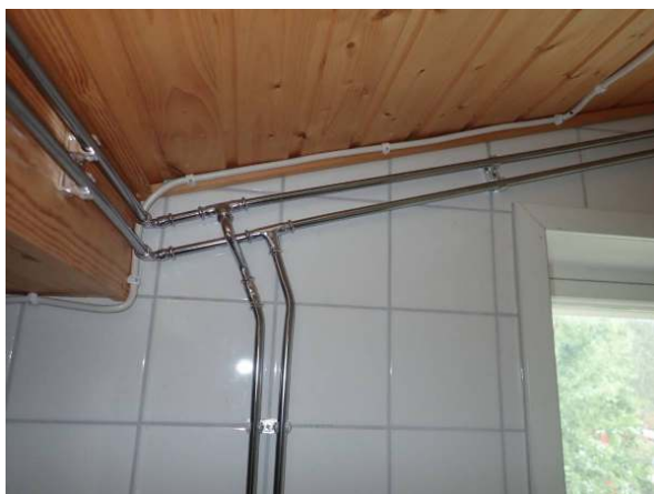
62. Vesijohdot ovat pääosin kromattua kuparia.
