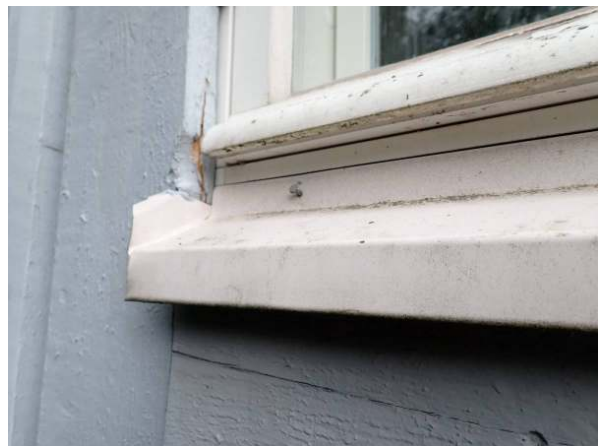
39. Pellityksien liitoskohdissa todettiin paikoin epätiiveyttä.
