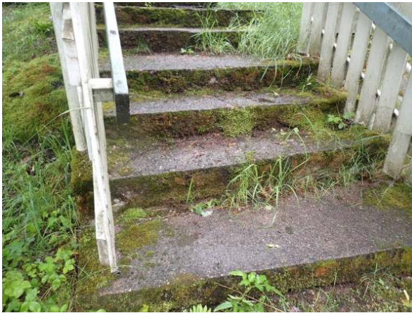
9. Sisäänkäynnin betoniset portaat ovat kuluneet ja ikääntyneet.
