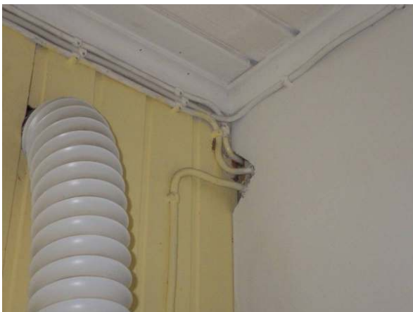
80. Kaapeliläpiviennit tulee tarkastaa ja tiivistää.
