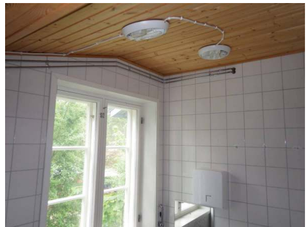
84. Pesuhuoneen valaisimet tulee uusia tai varustaa vastaavien valaisimien suojakansilla.
