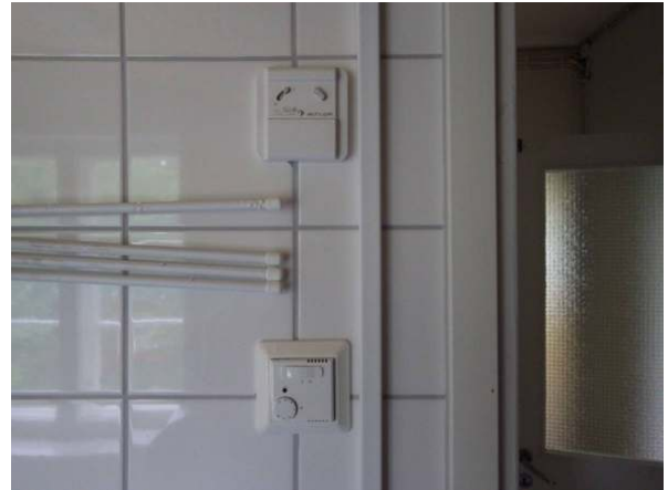
86. ...ja pesuhuoneessa lattialämmitys.
