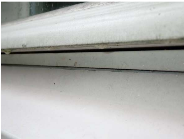
36. Vesipellityksien asennuksissa on paikoin puutteita.
