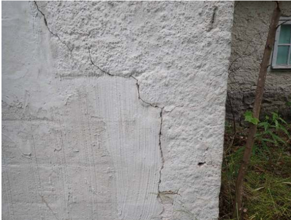
20. Sokkelissa on halkeama
