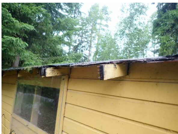
15. Varaston katon reunassa on vaurio.
