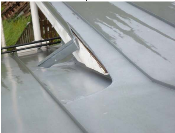
46. Reunapellitys on vääntynyt ja siitä saattaa päästä sadevesiä rakenteeseen.
