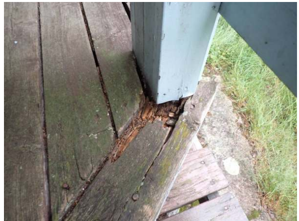
12. Terassin puuosissa on vähän lahovauriota.
