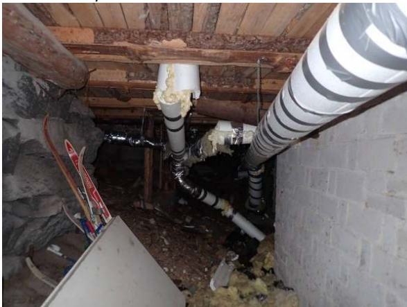
28. Alapohjatilassa olevia viemäriputkia.
