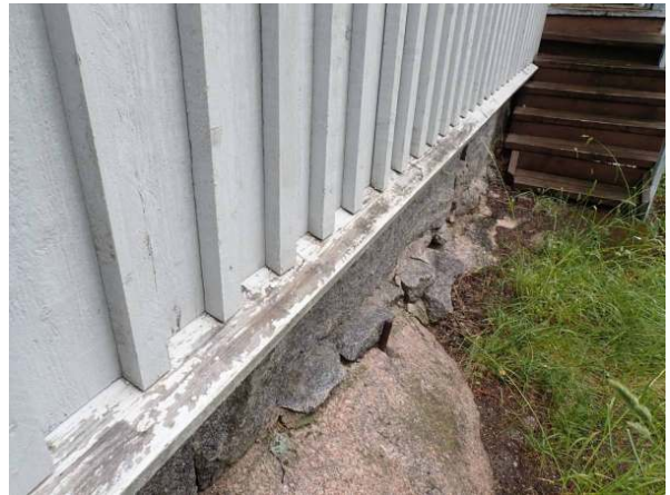
33. Ulkoseinän alaosassa olevan vaakapuun maalipinnoilla on kulumaa.
