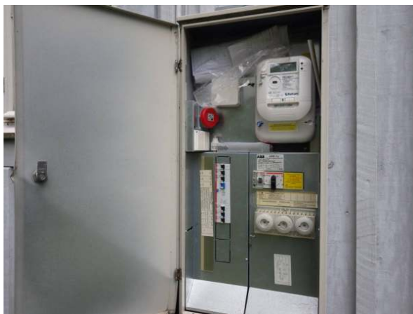
76. Sähköpääkeskus, jonka murrettu ovi tulisi uusia.
