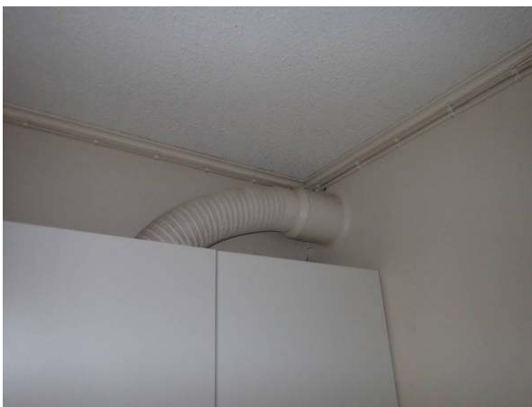
70. Ilmanvaihtokanava keittiön liesituulettimelta.
