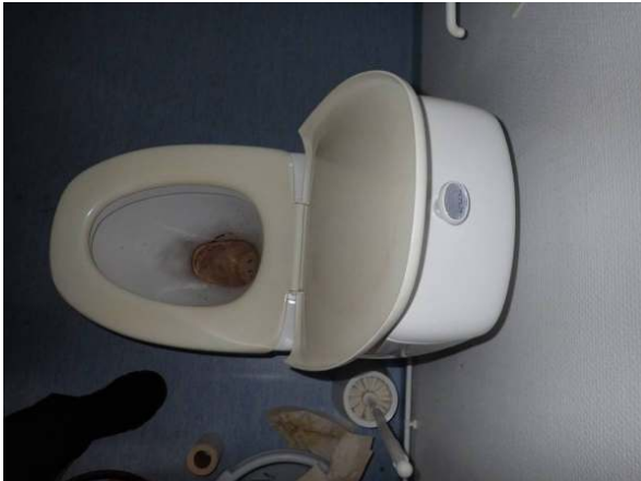
65. WC istuin 2. kerroksen WC tilassa.
