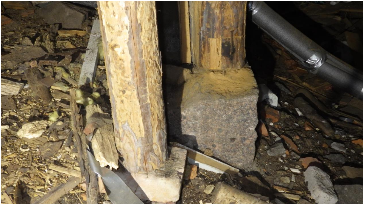
Kuvat 5 a-b. Rakenteiden tuennat vaikuttivat paikoin puutteellisilta.
