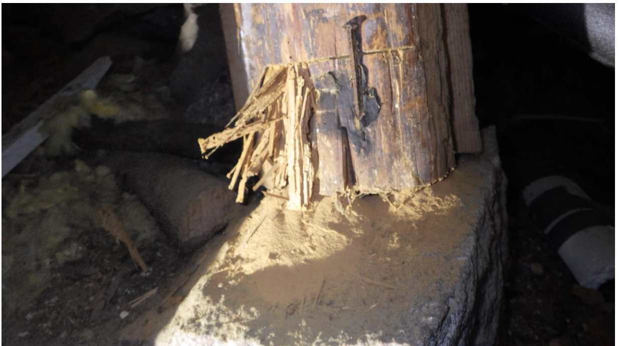
Kuva 4. Ryömintätilan puuosissa havaittiin paikoin lahovaurioita. Lahovaurioita havaittiin kuitenkin vain yksittäisissä paikoissa.
