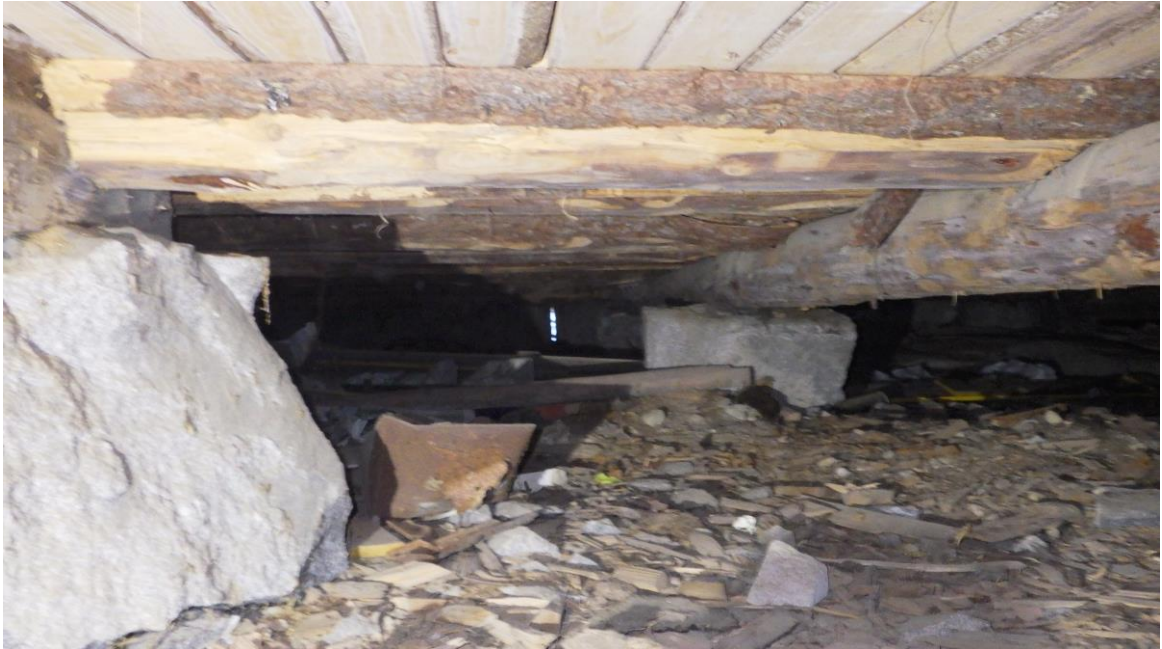
Kuva 2. Alapohjarakenne on puurakenteinen ja eristeenä rakenteessa on purueristettä ja ainakin paikoin lisäksi mineraalivillaa ja olkea. Alapohjarakenteessa on koko rakennuksen alalla tuulettuva ryömintätila, jossa mahtuu ainakin lähes kauttaaltaan ryömimään.
