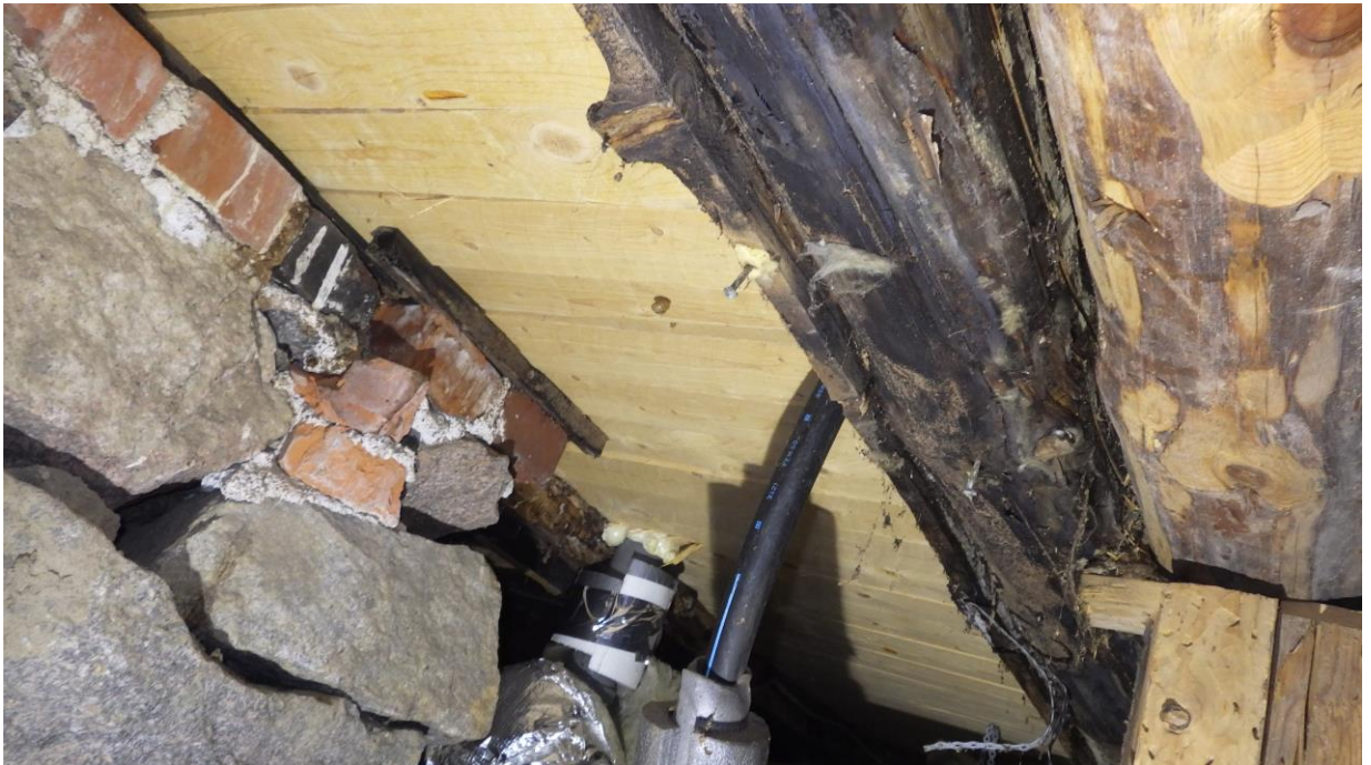
Kuva 3. Alapohjarakenteen puuosissa havaittiin paikoin tummumaa. Tummumaa havaittiin vain yksittäisissä paikoissa. Kuvassa näkyvässä keittiön kohdalla olevassa puurakenteessa ei havaittu kuitenkaan puupiikillä lahovauriota.
