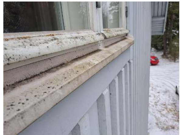
33. Ulkopinnat hieman likaisia. Vesipellit kiinnitetty nauloin.
