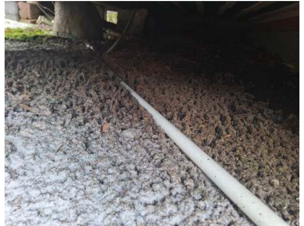
96. Nousujohto asennettu määräysten vastaisesti.
