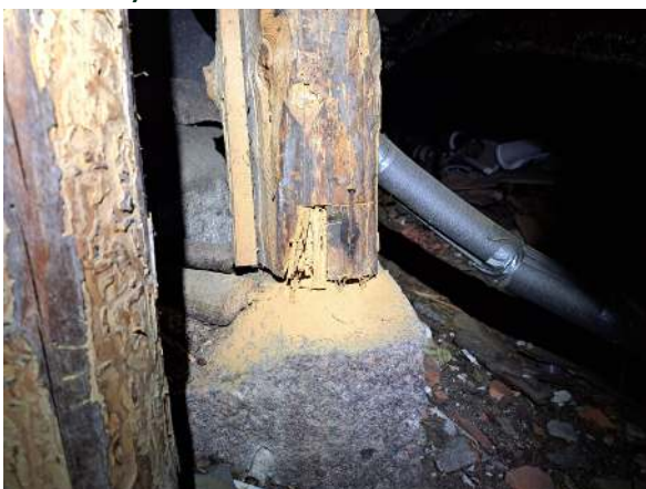
20. Alapohjan rakenteissa lahovaurioita.
