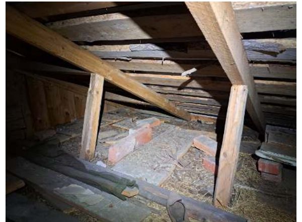
51. Tuuletusväli räystäällä vähäinen.
