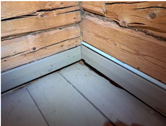
63. 2 krs. yhden huoneen nurkassa lattia hieman painunut. Rakenteet tulisi avata.
