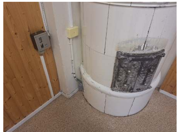
116. Pystyuuniin on asennettu sähkövastus.
