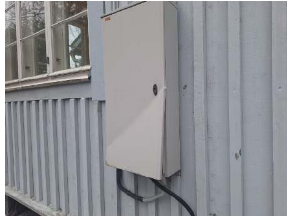
92. Sähköpääkeskuksen kansi on vääntynyt.
