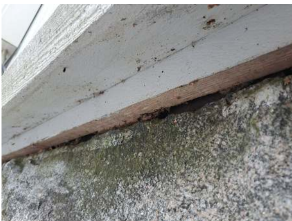
31. Paikoin tuuletusväli on matala.
