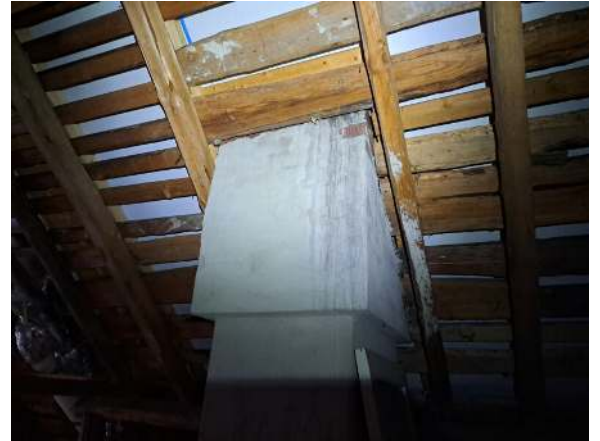
49. Hormin liittymässä mahdollisesti vanhoja vesijälkiä.
