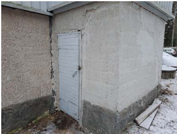
40. Tekninen tila / vesipumpputilan ovi.
