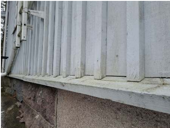
29. Verhouksen alaosissa kulumaa.
