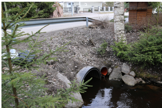
Kuva 19. Lamminojaan laskevan hulevesiputken purkukohdalla on hyvin niukasti tilaa hulevesiratkaisulle.
