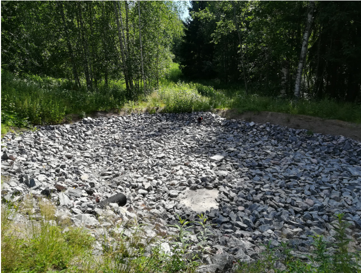
Kuva 45. Vuohenojankujan viivytyssallas. Vesi tulee altaaseen vasemmalla olevasta putkesta ja poistuu takalaidassa näkyvästä putkesta.
