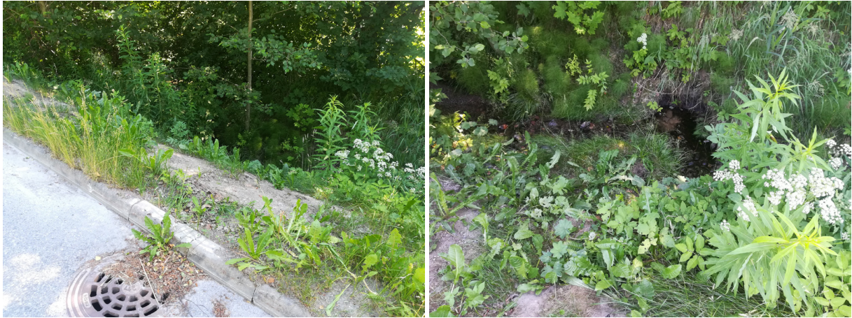
Kuva 29. Hulevesikaivoon tulee Päivärinteentiellä vettä kahdesta suunnasta. Siitä vesi puretaan avo-ojaan.
