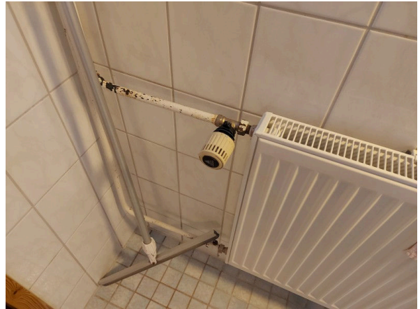
30. Saunaosastolla on vanhempia patteriventtiileitä.
