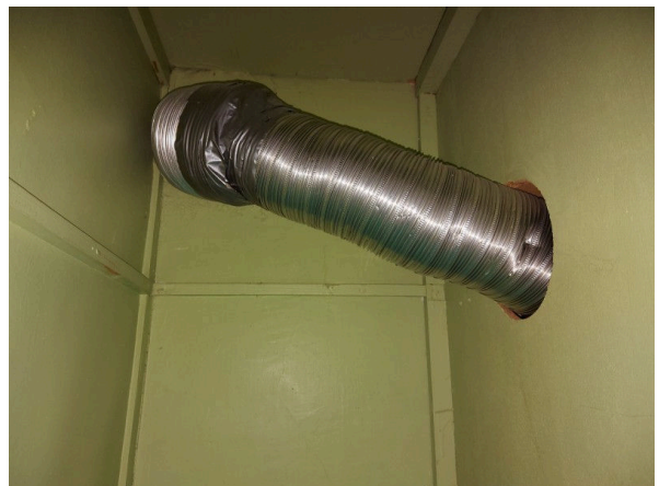
45. Yläkerran huoneiston keittiön poistoputki.
