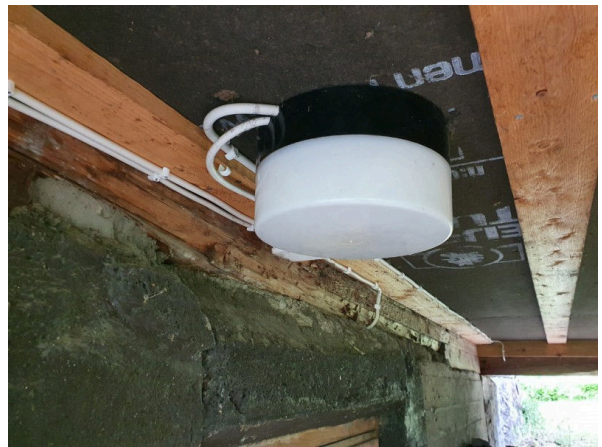
50. Rakenteisiin asennettu valaisin.
