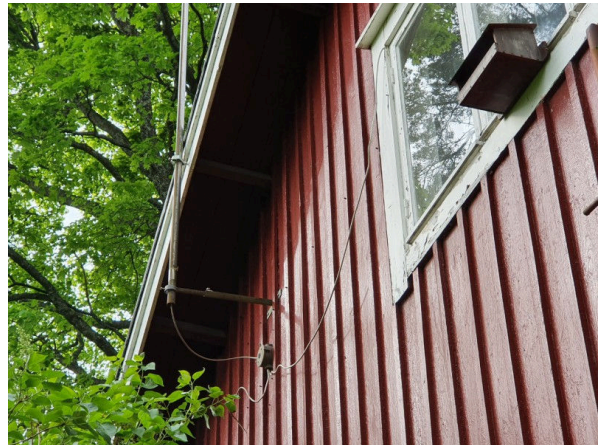
57. Harava-antennia ei ole maadoitettu.
