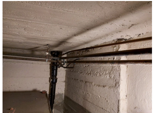
28. Lämpöjohtoja ei ole eristetty.
