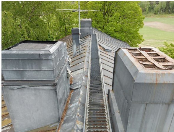
34. Huippuimurit ja hormit.
