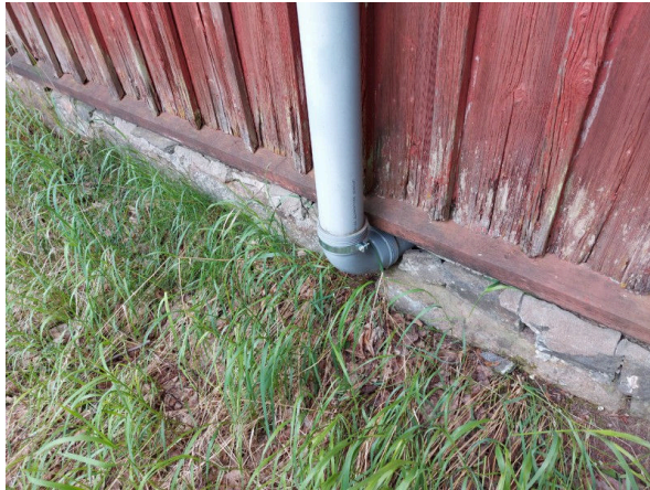
28. Viemärin tuuletusputki talon ulkopuolella.
