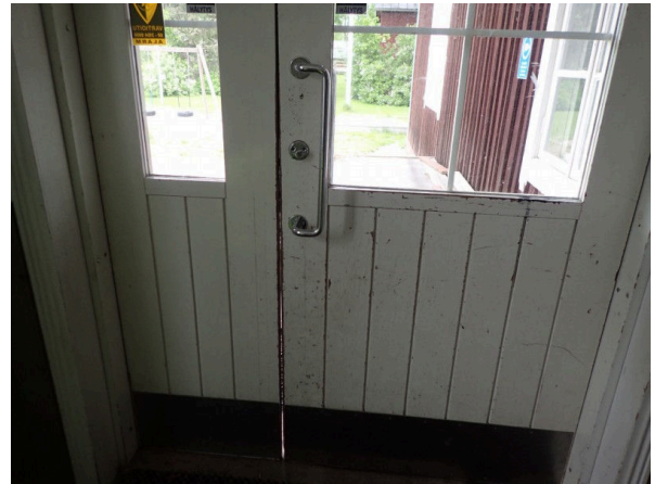
16. Ulko-ovi on varsin epätiivis.
