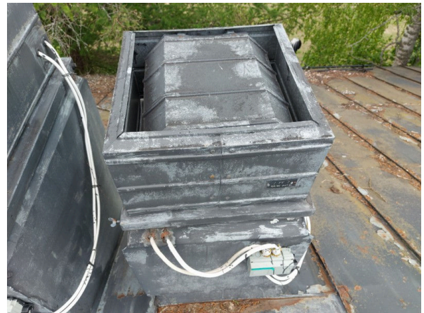
35. Ilmanvaihtokoneiden tarkka ikä ei selvinnyt kylteistä.
