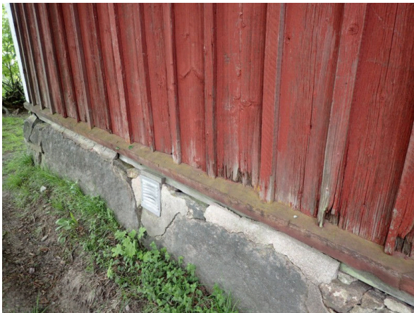
10. Julkisivuverhouksen alaosat ovat huonossa kunnossa.
