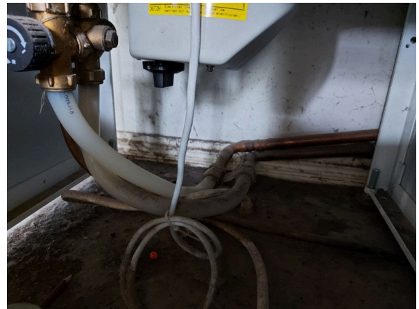
26. Varaajan alla on säätimet veden lämpötilalle.
