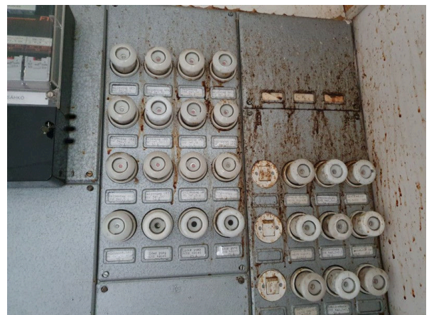
43. Pääkeskuksen päälle on roiskunut likaa.
