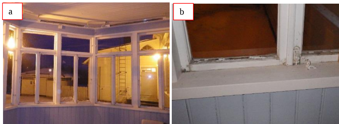
Kuvat 26 a ja b. Kuistin ikkunat (a) ovat yksilasiset, ikääntyneet ja puitteiden alaosissa on lahoa (b). Kuisti on kylmää tilaa.
