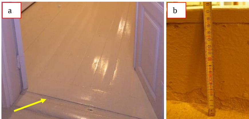
Kuvat 12 a ja b. Ensimmäisessä kerroksessa kartanon puolella kynnyksen ja lattia-laudoituksen välissä on selvä rako (a, nuoli). Ensimmäisen kerroksen puulattiat ovat hyväkuntoiset ja maalipinta on ehjä, lattia-laudojen välissä ei ole selviä rakoja. Siivessä lattian pinta on 17,5 cm kartanon lattiapintaa alempana (b).
