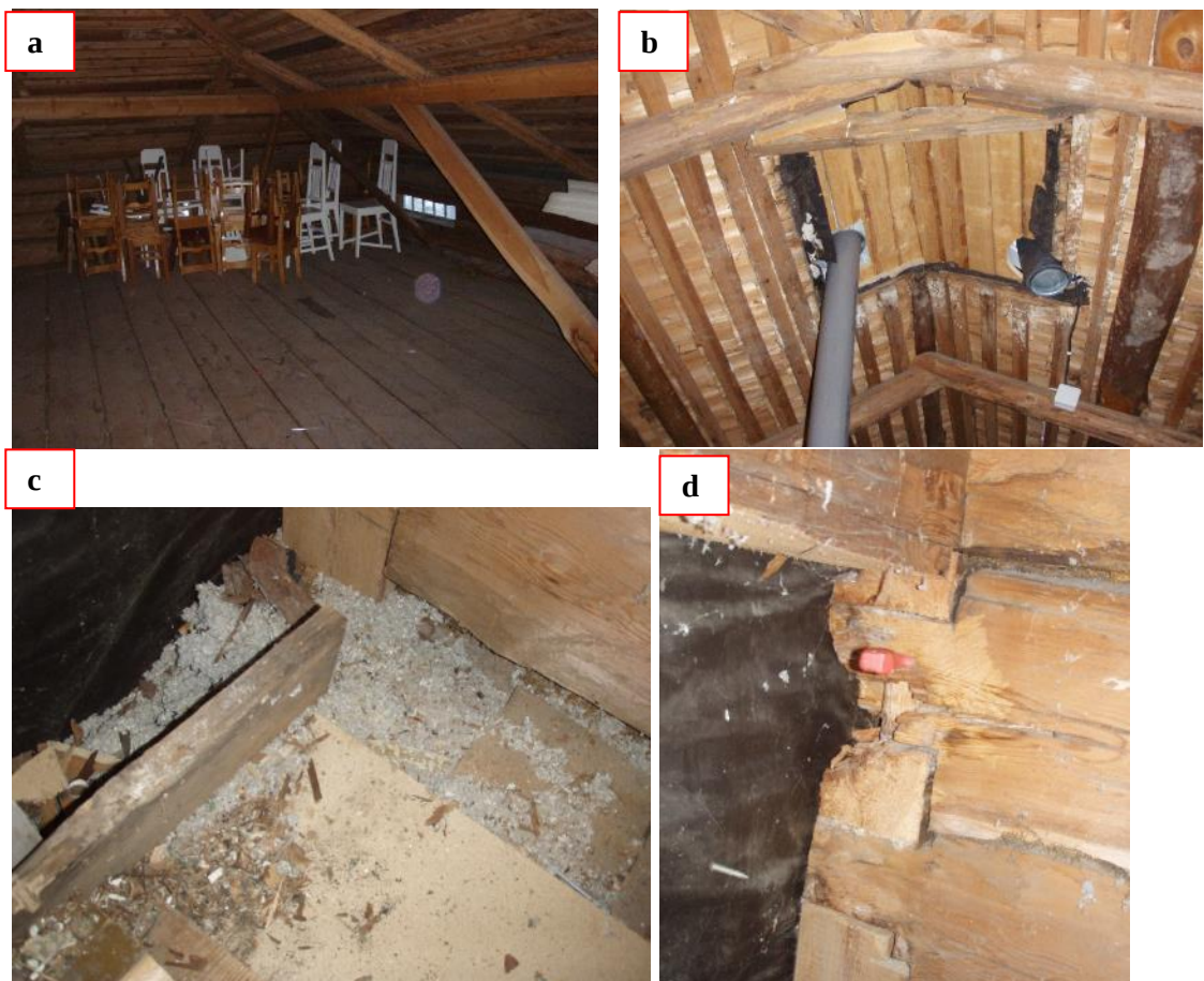
Kuvat 61 a-d. Kartanon pohjoispäädyn ullakkotila (a). Tilassa on koneellinen poisto ja puurakenteissa vanhoja vauriojälkiä (b). Nurkkakohta on korjattu (c) ja korjauskohdassa havaittiin puunlahoa (d). Ikkunat olivat heikkokuntoiset.
