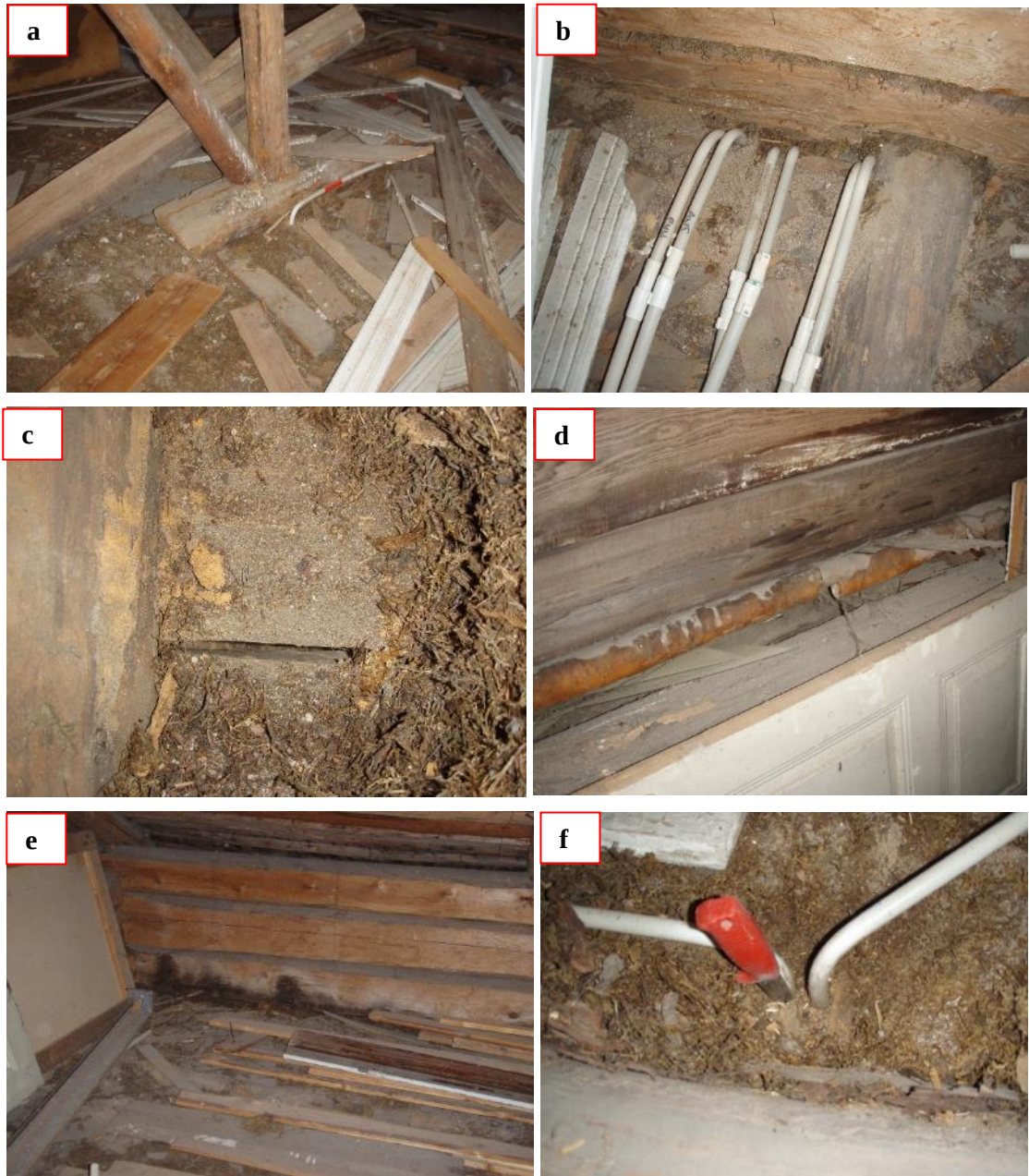
Kuvat 59 a-f. Korkea ullakkotila kartanon keskellä. Ullakkotilassa on mm. epämääräistä tavaraa ja lehtiä, linnun pesä ja jätöksiä (a). Seinien alareunassa on tummia jälkiä, puupinnoilla vanhoja kosteusjälkiä (e) ja tilkkeenä on käytetty tuulensuojana tuohta, joka on käännetty hirsien väliin (d). Lohoa ei havaittu ja tarkastellut puurakenteet olivat kuivia. Kattokannatinhirsien kuorikerrokset olivat puutuholaisen syömiä (ei ulottunut syvälle). Täyttökerros on avoin, laudoittamaton ja täyttökerros on epätiivin puulattian päällä (c). Täyttökerroksen läpi menee avoimia sähköläpivientejä ja suojaputkia (b, f). Yläkolmio on tehty laudoista, hirsi ei ulotu ylös asti. Ikkunat olivat heikkokuntoiset.
