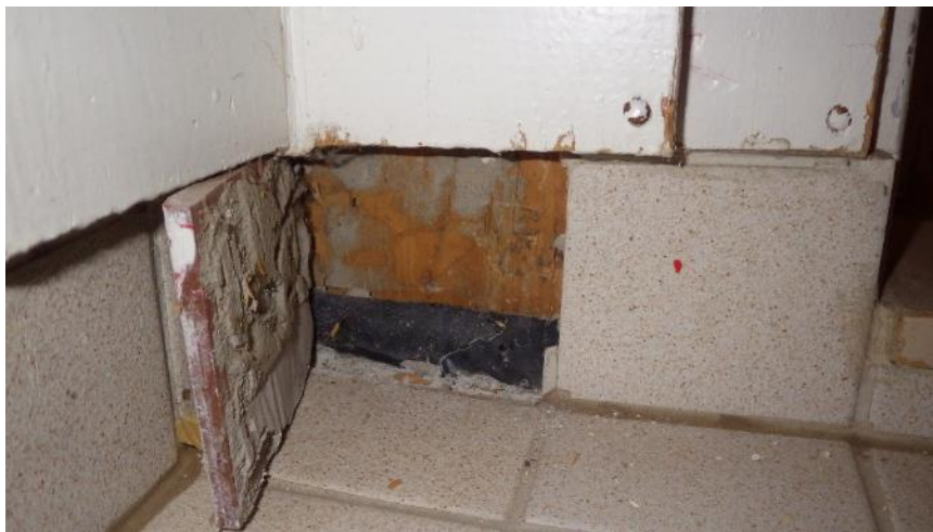
Kuva 16. Siiven saunan pukuhuoneessa keraamisen ylösnoston takana on hirsi. Vedeneristystä ei havaittu.
