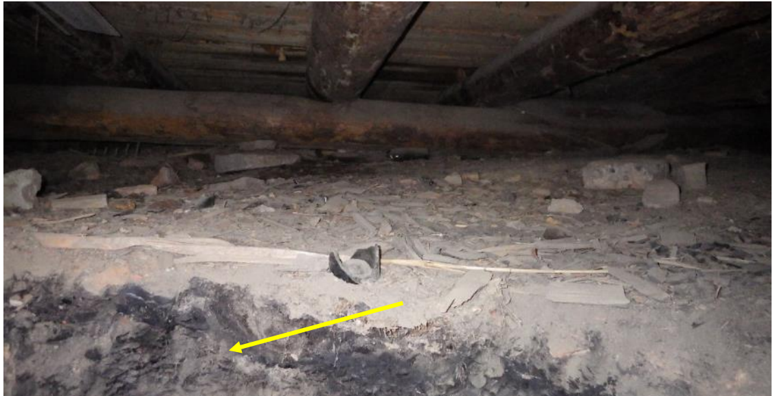
Kuva 4. Ryömintätila kuvattuna kartanon kohdalla lännestä itään. Kantavat puurakenteet ovat hyvin lähellä tai kiinni hienojakoisessa hiekkamaassa, jonka päällä on kuivaa orgaanista ainesta kuten olkia, puiden lehtiä, purua ja puun kappaleita. Hiekkakerroksen alla näkyy musta hiiltynyt palamiskerros (nuoli), joka liittyy terassin läheisyydessä tapahtuneeseen tulipaloon. Ryömintätila oli aistinvaraisesti arvioituna kuiva.
