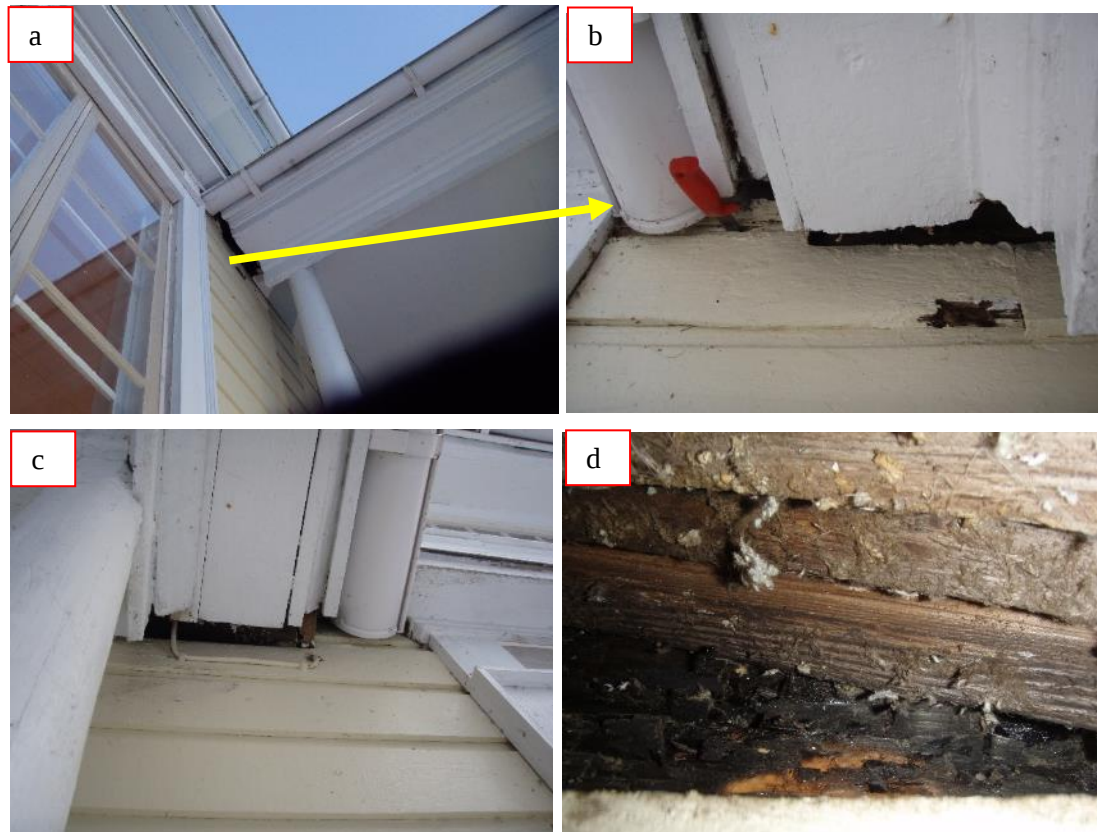
Kuvat 31 a-d. Kartanon takapihan kuistin katoksen ja ulkoseinän välissä (a) vasem-malla puolella havaittiin lahoa julkisivulaudoituksessa (b). Kuistin molemmin puolin ha-vaittiin palanutta hirttä (c, d).
