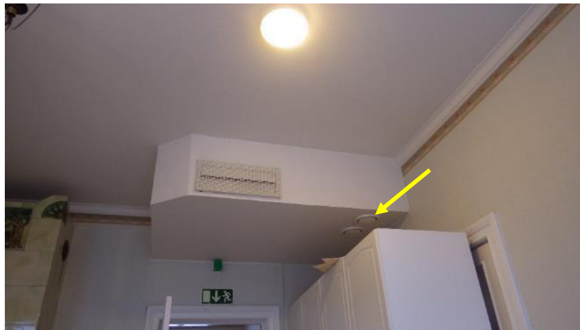
Kuva 71. Yläkerran huoneessa 21 poistoilmaventtiilien päätelaitteet ovat ahtaasti kaapin päällä, mikä hankaloittaa tilan tulo- ja poistoilman virtauksia ja tilan ilman oikeaa huuhtoutumista.
