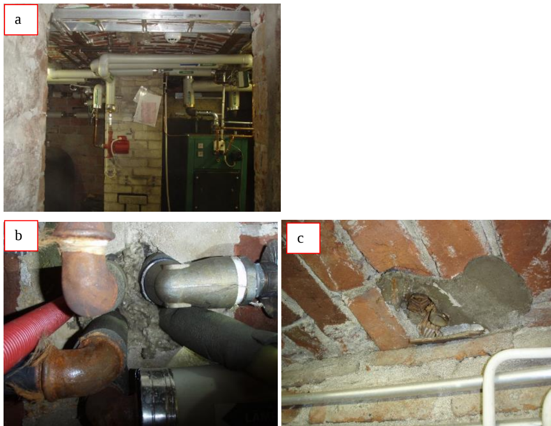
Kuvat 9 a-c. Kappaholvinen kellari sijaitsee rakennuksen siivessä ja siellä on lämmönjakohuone (a). Kellarissa on mineraalivillalla tilkittyjä (b) tai avoimia putkiläpivientejä (c). Putkien ympärillä havaittiin myös aaltopahvia ja jouhia (b,c). Lattia oli betonia ja sen alaosassa oli kosteuden liikkumiseen viittaavia suolakiteymää (ei kuvaa).
