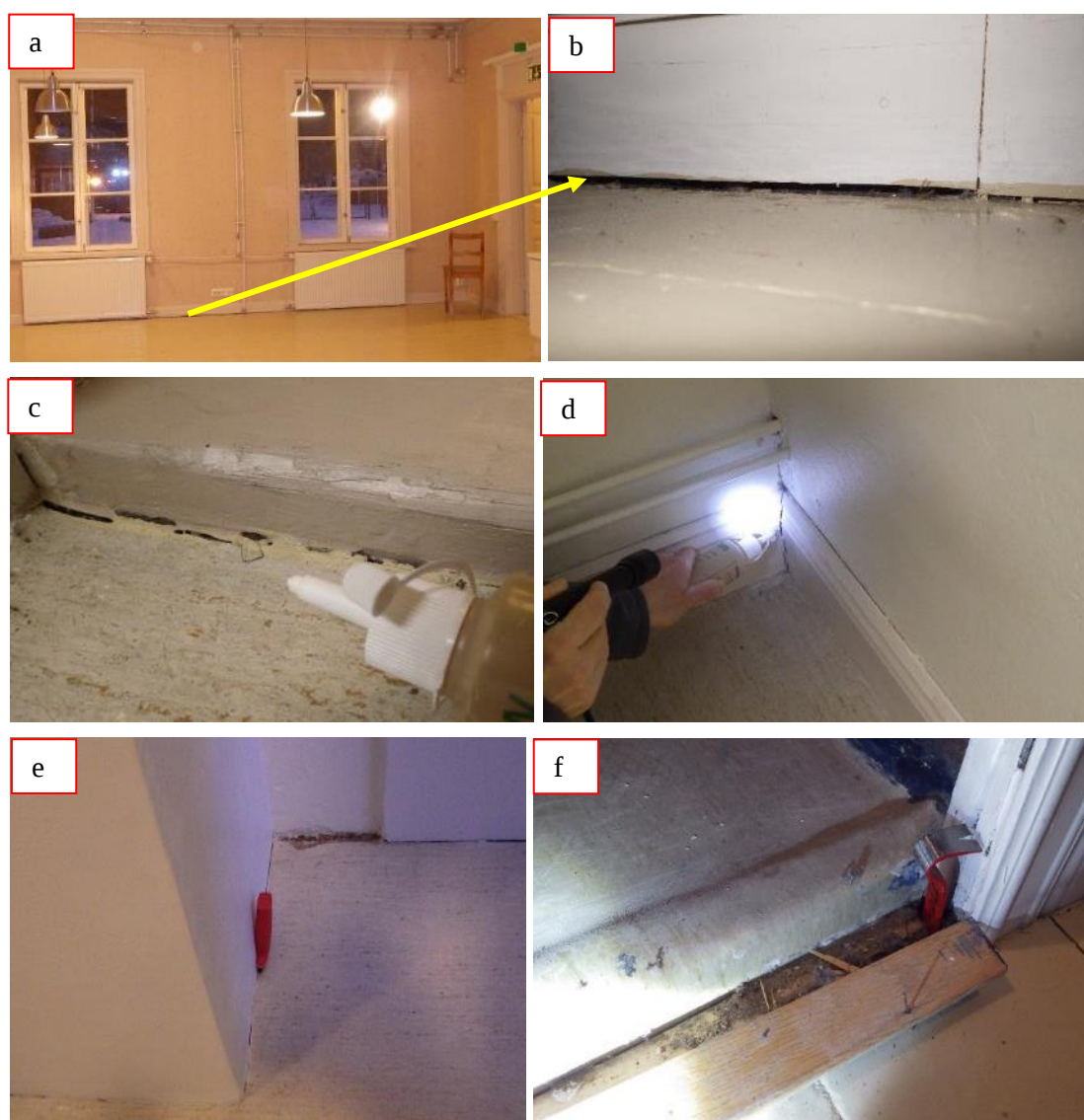
Kuvat 11 a-f. Kartanossa puulattian ja jalkalistan välissä (a, b) ja siivessä kynnyksen ja lattian välissä (c) on paikoin selvä raot. Ilmavirtaukset olivat merkkisavulla sisätilaan päin. Epätiivyyttä on myös siiven jalkalistojen liitoskohdissa (d), lattian ja hormin liitoksessa (e) sekä kartanon puolella lattiarakenteiden välillä (kuva portaikon alta) (f).
