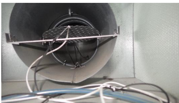
Kuva 73. Tuloilmakanavien päät olivat likaiset.
