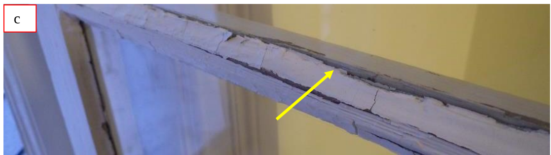
Kuvat 29 a-c. Siivessä ikkunakarmit ja puitteet ovat heikkokuntoisemmat kuin kartanossa. Puitteen ja karmen väliin jää selviä rakoja (a), ylimaalatut tiivisteet ovat ikääntyneet tai niitä ei ole. Maali on hilseillyt ja lasitusmassa on ikääntynyt, lohkeileva (b). Ikkunapuitteiden välinen rako aiheuttaa vetohaittaa.
