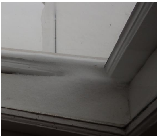
Kuva 6. Huoneen 8 ikkunat oli uusittu mutta muualla rakennuksessa ikkunanpuitteet olivat epätiivit ja lunta oli kulkeutunut puitteiden väliin.
