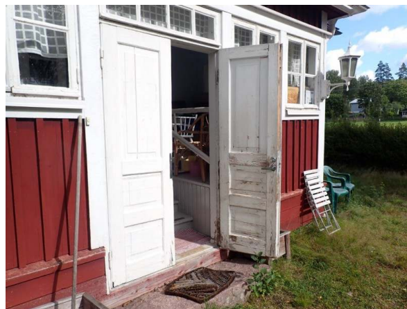
31. Ulko-oven sisäpinnoilla on kulumaa.
