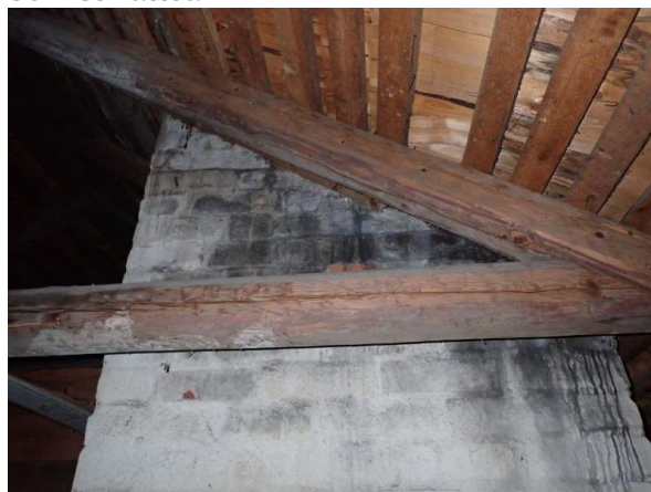
37. Hormin rappauspinnoilla on tummentumaa ja valumajälkiä.
