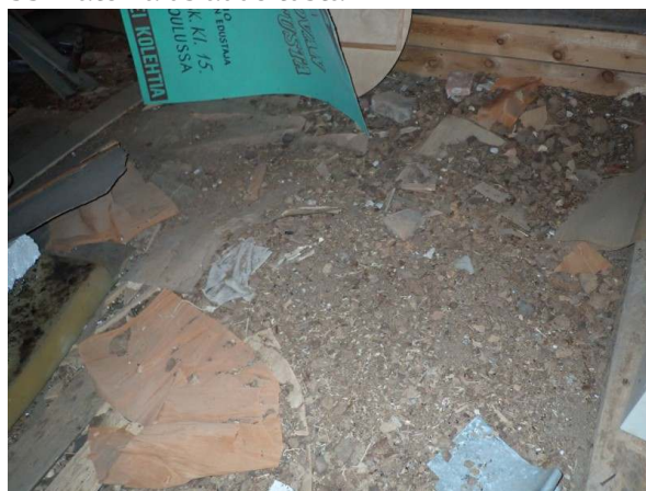
41. Yläpohjarakenteen eristekerros on sekalaista hiekkaa ja purua.
