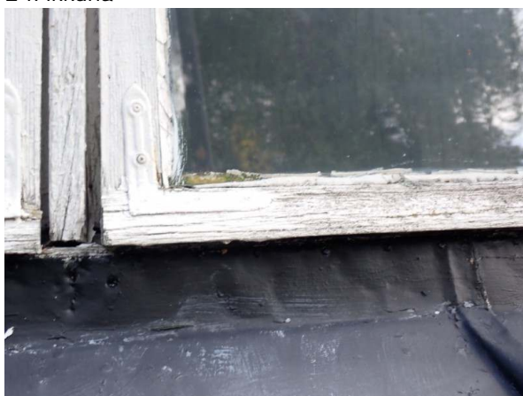
26. Ikkunapuite on maalipinnoiltaan kulunut.
