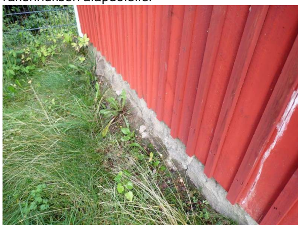
3. Rakennuksen vierustalla on humuspitoista maa-ainesta
