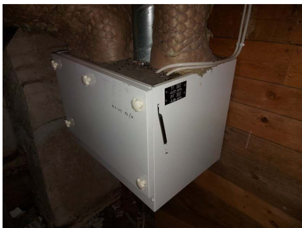
54. LTO kone ullakkotilassa.
