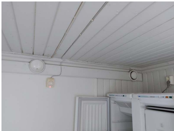
56. Tuloilma- ja poistoventtiilit.
