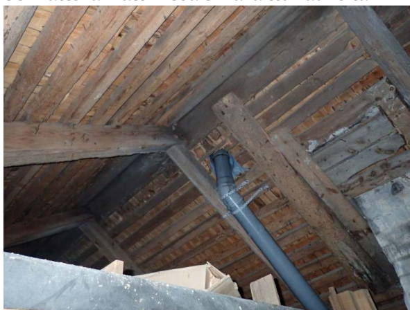
40. Viemäriputkea ei ole eristetty
