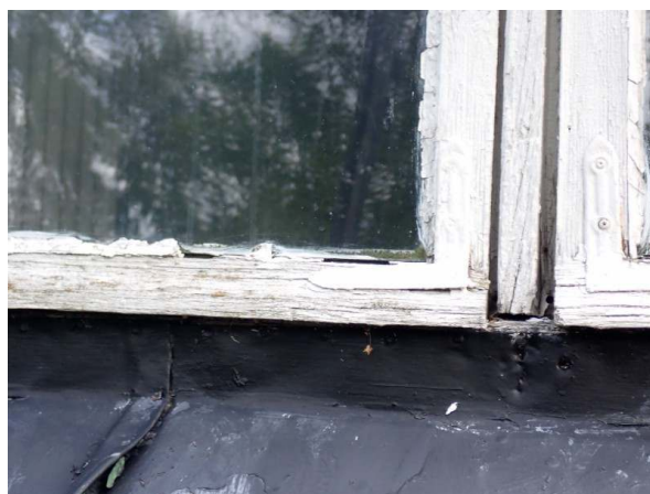
25. Ikkunapuitteissa on kunnostustarvetta.
