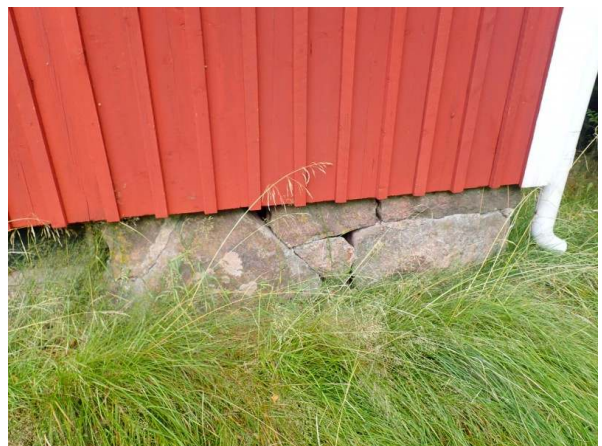
13. Sokkelissa on havaittavissa painumaa
