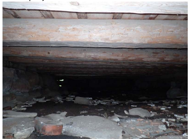
17. Alapohjan maa-aines on kosteaa
