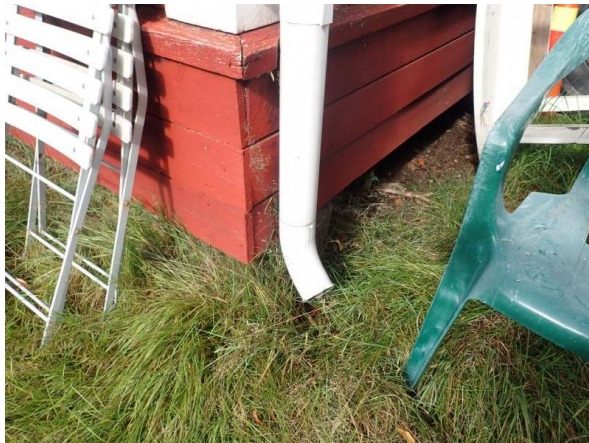
1. Sadevesiä on johdettu rakennuksen vierustalle, jolloin vesiä on ohjautunut myös rakennuksen alapuolelle.
