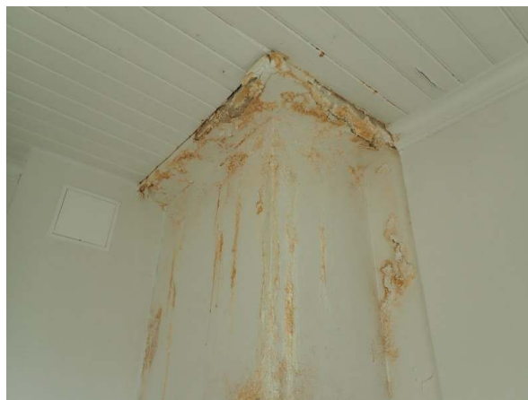
2. Kosteuden aiheuttamia vauriojälkiä.
