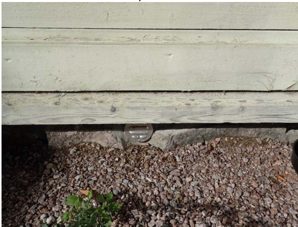
32. Alapohjatilan tuuletusaukko on liian lähellä maanpintaa.
