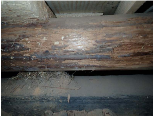
30. Kannattimessa on pintavaurioita
