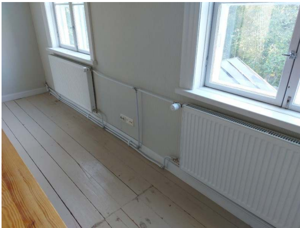
76. Lämmityspatterit ja termostaattiset patteriventtiilit.
