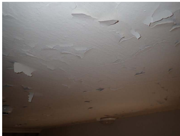
67. Sisäkatosta irtoaa maalipintaa
