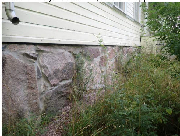
9. Syöksytorvi on asennettu liian korkealle
