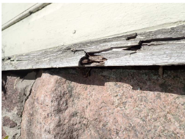
36. Ulkoseinän alaosassa on lahovauriota
