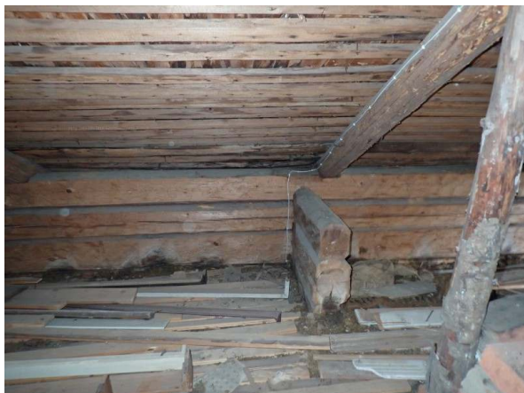
60. Mahdolliset tummentumat puurakenteiden pinnoilla saattavat olla ilmavuotojen aiheuttamia.
