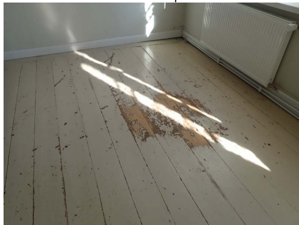
69. Lattialaudoitus on kulunut
