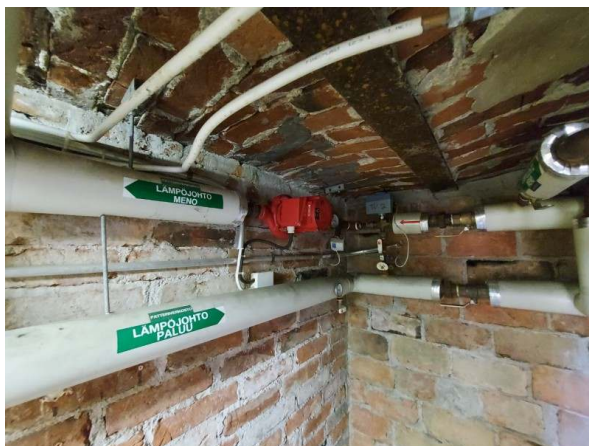
74. Patteriverkoston putkia ja kiertovesipumppu pannuhuoneessa.
