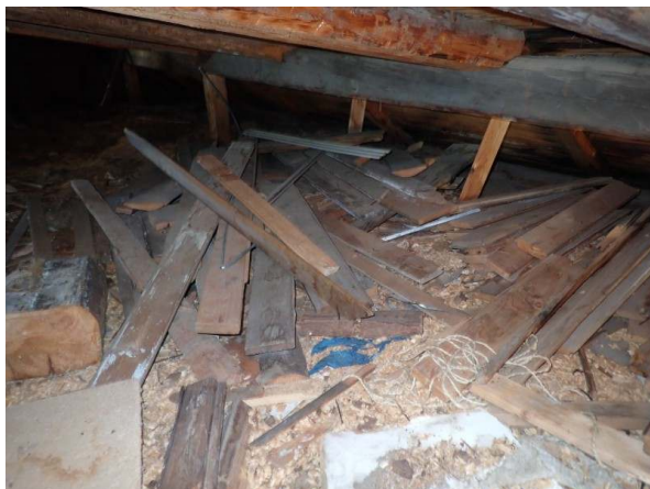
56. Yläpohjatilassa on paikoin ylimääräistä tavaraa
