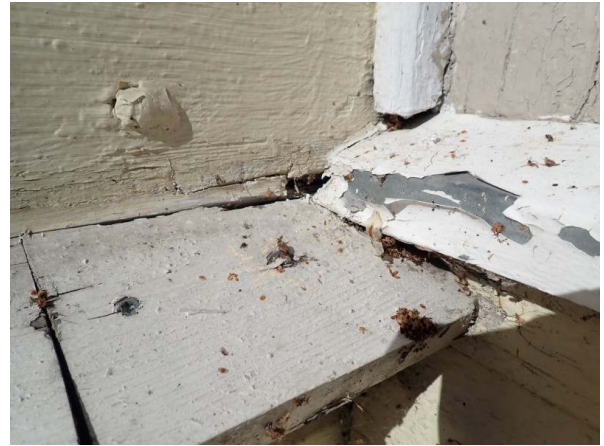
41. Kuistin ja ulkoseinän liitoskohdassa on lahovaurio
