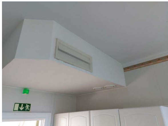
89. Tuloilmaventtiili ja poistot.
