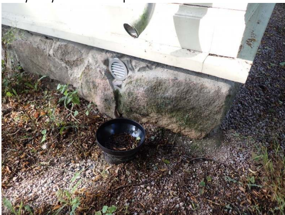
5. Syöksytorvi on asennettu liian korkealle kaivosta
