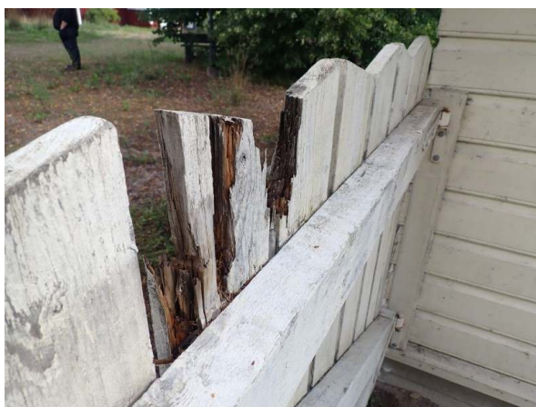
13. Aidassa olevaa lahovauriota.
