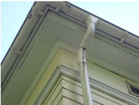
3. Syöksytorvissa on paikoin vuotoa
