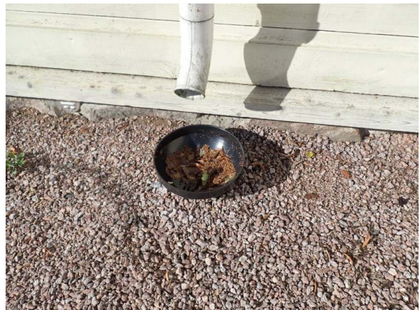
4. Sadevesien ohjausta kaivoon
