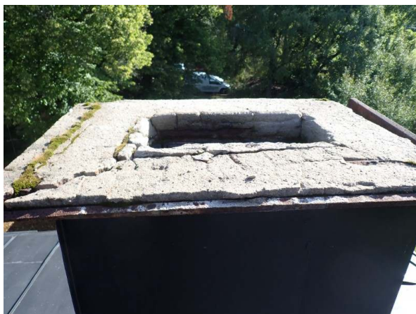
1. Lakivalu on vaurioitunut, jolloin pellityksen väliin pääsee sadevesiä.
