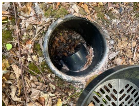
Etupihan sadevesiviemärointi oli lähellä maan pintaa
