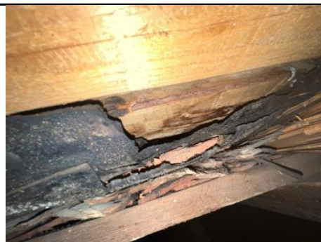
Vanhassa huopakatteessa oli voimakas PAH- yhdisteiden haju
