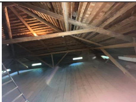
Päädyn ullakolta. Tilassa oli voimakas PAH-yhdisteiden haju
