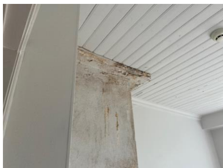
Muuratun hormin pinnassa havaittiin vanhoja vuotojälki. Hormin pinta oli pintamittauksen perusteella kuiva.
